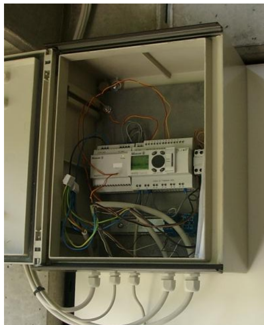
Abbildung 7-34: Das Innere des Schaltschranks im Klassenraum 37
