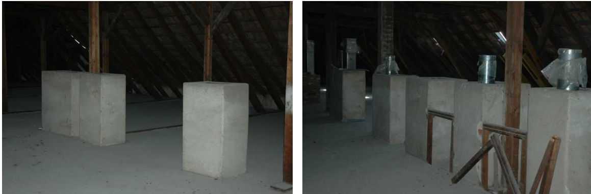
Bild 26: Ventilationskamine im Dachraum, Bestand sowie mit Belegung durch neuzeitliche Lüftungskanäle, AB Haase
