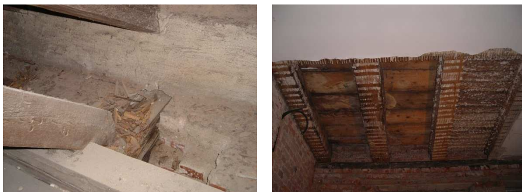
Bild 16: Befall mit Hausschwamm, Würfelbruch
