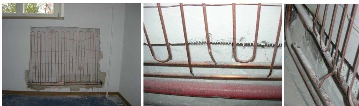
Bild 25: Schäden an der Wandheizung, nachträgliche Reparaturen, während der Bauphase, AB Haase
