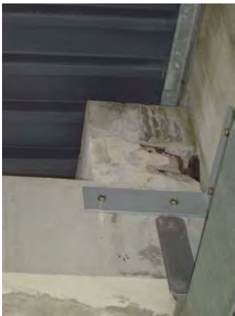
Bild 10 Kragarm mit Abplatzungen infolge Korrosion, AB Haase
