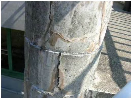
Bild 8 Wendeltreppen-Spindel, Abplatzungen infolge Korrosion, AB Haase
