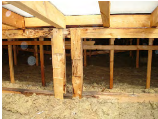
Bild 17 Kaltdach mit Polyacrylplatten und zerfallender Mineralfaser, AB Haase
