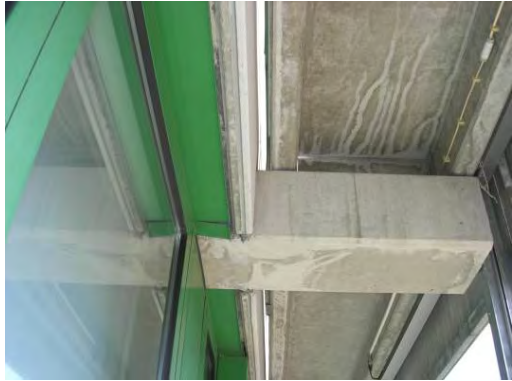
Bild 6 Auskragende, thermisch nicht getrennte Stahlbetonkonsolen, AB Haase
