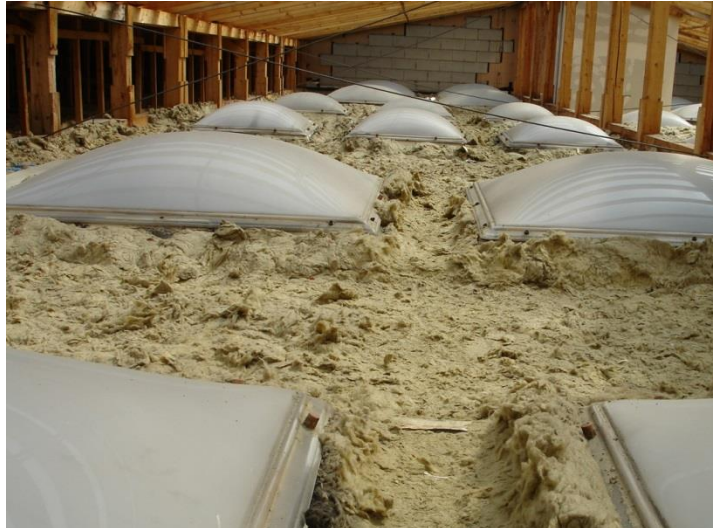
Bild 7: Lichtkuppeln der alten Flachdächer mit Aufständigung des Blechdaches
