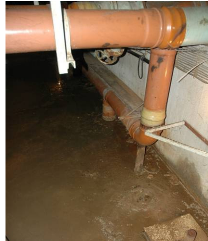
[Bild 7: undichte Entwässerung]
