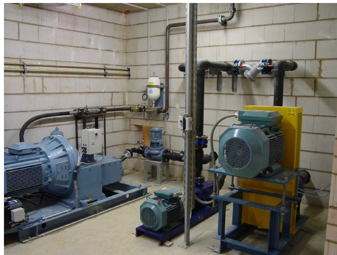
Abb. 2.14: Maschinenraum, Links: Hochdruckpumpe, Mitte: Niederdruckpumpe, Rechts: Schlammpumpe
