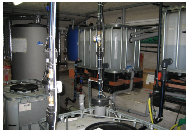
Abbildung 21: Betriebswassertanks, hinten zentraler Wärmespeicher und Urintank (blau)
