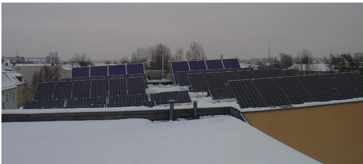
Abbildung 8: Neu errichtetes Dach, max. ausgenutzt: 10,4 kWp-Solaranlage und 8,8-kWp-PV-Anlage, Dach-WKA vorgesehen
