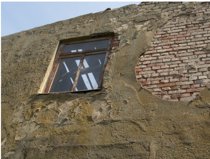
Detailansicht Fassade und zerstörte Dachkonstruktion
