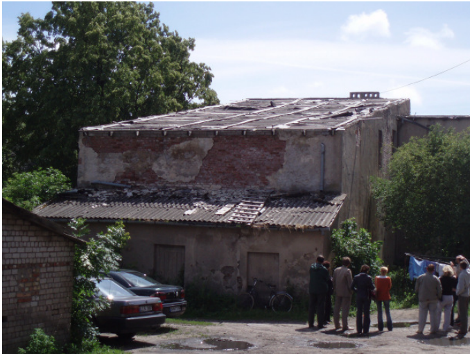
Rückansicht des Kulturos namai im Dorf Rusne. Die Ansicht lässt den Zustand des Dachs erahnen.
