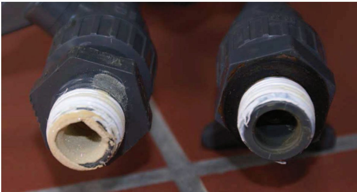
Abbildung 32) Anlage A-1 und A-2: Ablagerungen im Zulauf (rechts) und im Ablauf (links) der In-line -Elektrolyse-Anlage A-2 nach einer Standzeit von insgesamt 10 Wochen und einer Betriebszeit von <10 Tagen. (Quelle: UBA, KESSLER)
