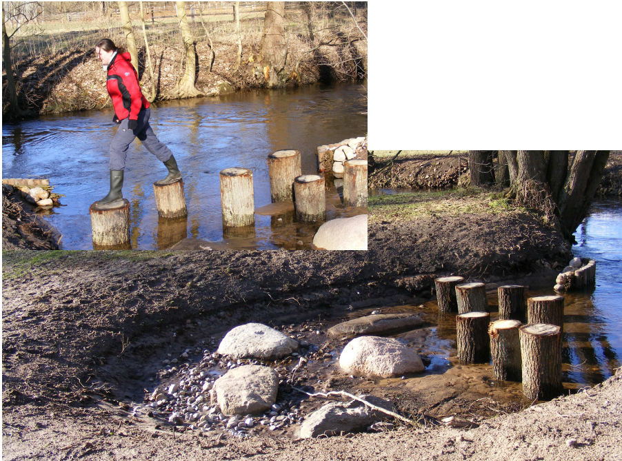
Abb. 89: Uferabflachung in Luhmühlen, in Kombination mit Steinen und Hochkant stehenden Eichpfählen, die zu Aktionen einladen.
