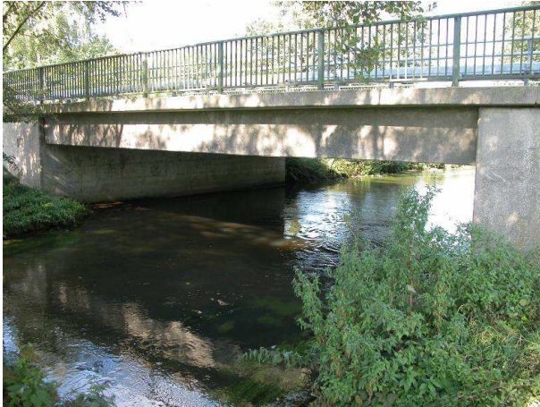
Abb. 93: Diese Brücke ohne Uferbermen kann eine Gefahr für den Fischotter darstellen (K20 über die Luhe bei Wetzen vor der Baumaßnahme).
