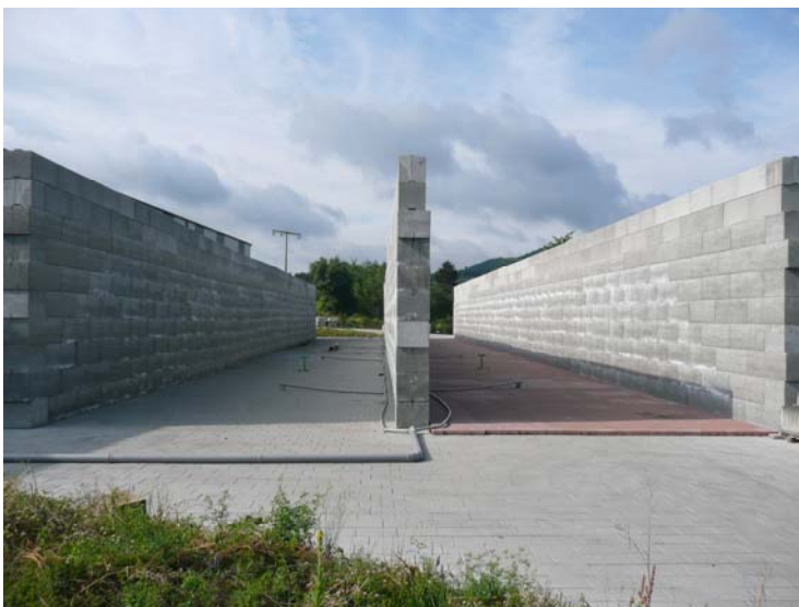
Abb.36: Canyon-Testfläche mit Abgasleitungen, Ansicht von Norden
