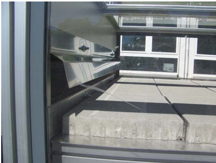
Abb. 23: Gaszufuhr und -leitblech, Ansicht in der Kammer
