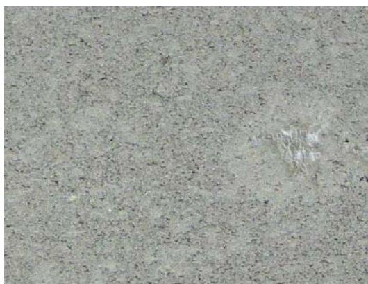
Abb 17. Entmischungen im Betonstein (schlierenförmig + punktförmig)
