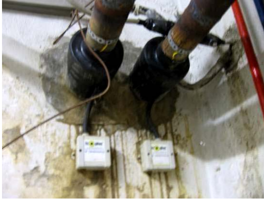
Bild 375 Fernwärmeanschluss Technikzentrale BT B
