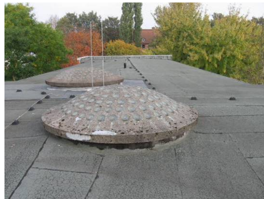
Bild 343 BT B Dachoberlichter
