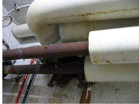
Bild 376 Übergang zur Nahwärmeleitung BT B zu BT A
