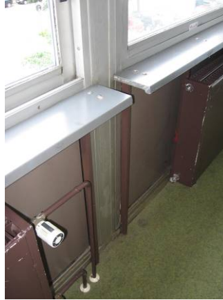
Bild 58 BT A Brüstung
