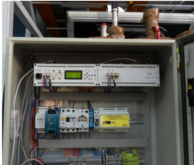
Abbildung 9.6: Erweiterung des Messsystems am Thermosiphon-Anlagen-Prüfstand
