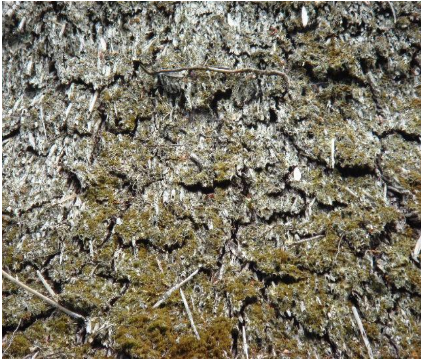
Linkes Bild: Reetdach im fortgeschrittenen Stadium der Zersetzung. Eine mehrere cm starke Rotteschicht mit Moos und/oder Flechten bedeckt das Dach. Bei längerer Trockenheit bilden sich Schrumpfungsrisse auf der Dachoberfläche.
