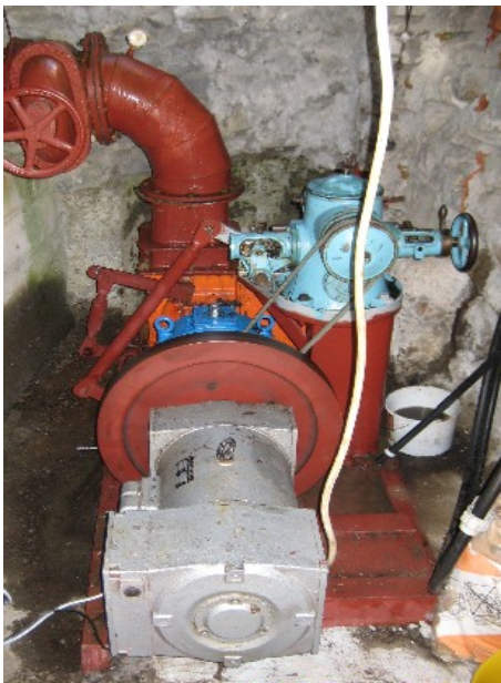
Abbildung 30: Peltonturbine mit 11 kW elektr. Leistung
