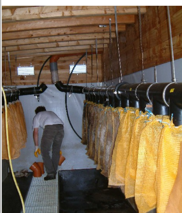
Abbildung 103: Filtersackanlage Bonn Matreier Hütte
