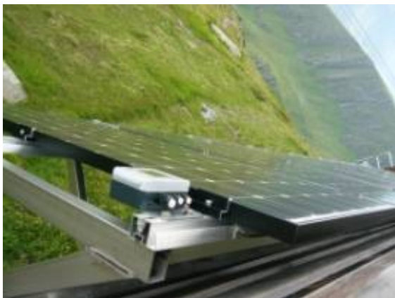
Abbildung 147: Sensorbox zur Überwachung der optimalen Leistung der PV-Module
