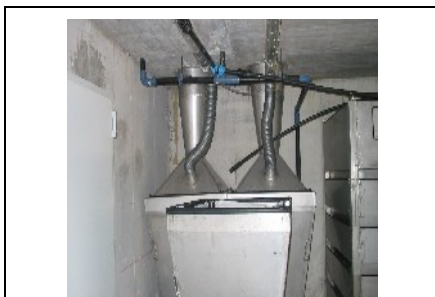
Abbildung 101: Trockentoilette (Fäkalbehälter und Abluft)
