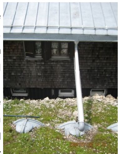
Abbildung 80: Dachwasserfassung Nördlinger Hütte
