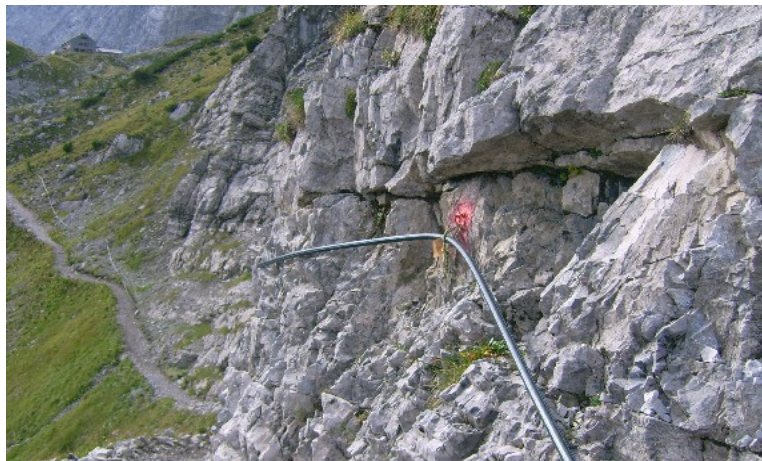
Abbildung 83: Wasserleitung (von Tiefbehälter) - Lamsenjochhütte
