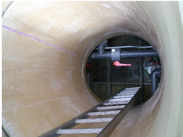
Abbildung 81: Einstieg in GFK-Tiefbehälter - Neue Traunsteiner Hütte
