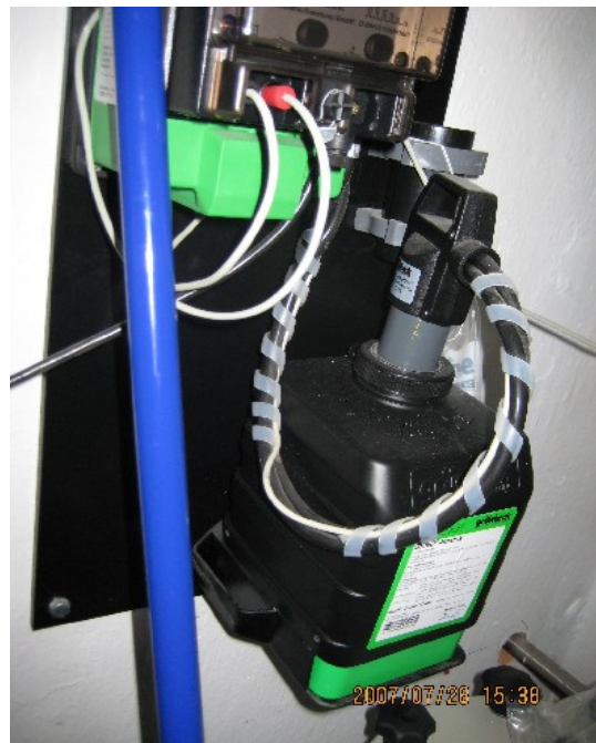
Abbildung 86: Wasseraufbereitung durch Chlorung auf der Nördlinger Hütte
