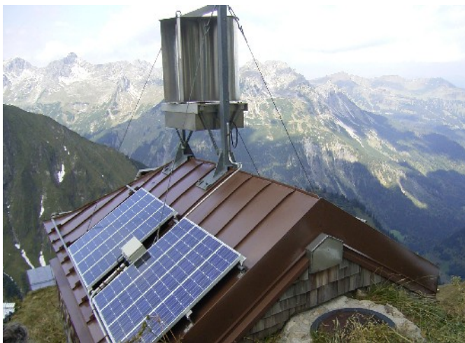
Abbildung 31: Windkraftanlage auf Hüttendach
