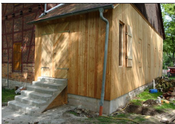
Abbildung 46: Anbau an bestehende denkmalgeschützte Gebäude der Sophienquelle für die Steuerung und das Hydraulikaggregat
