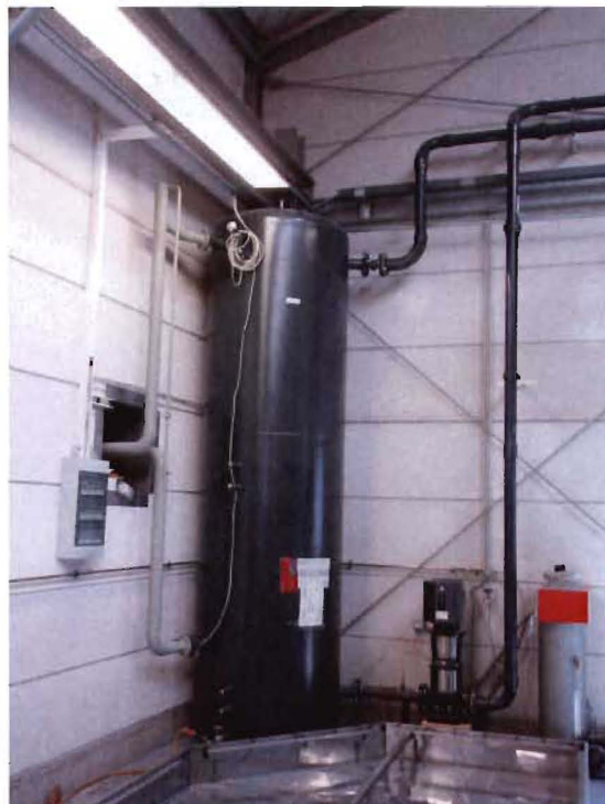
Abb. 2-2: Kaltwasserpuffer im Inneren der Produktionshalle (Mauerdurchbruch mit Leitungsdurchführung zu Seecontainer) mit Kreislaufpumpe und Entgasungsaggregat
