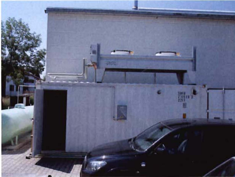
Abb. 2-3: Seecontainer mit Lüftaggregat zur Abfuhr von Wärme; links der Flüssiggastank
