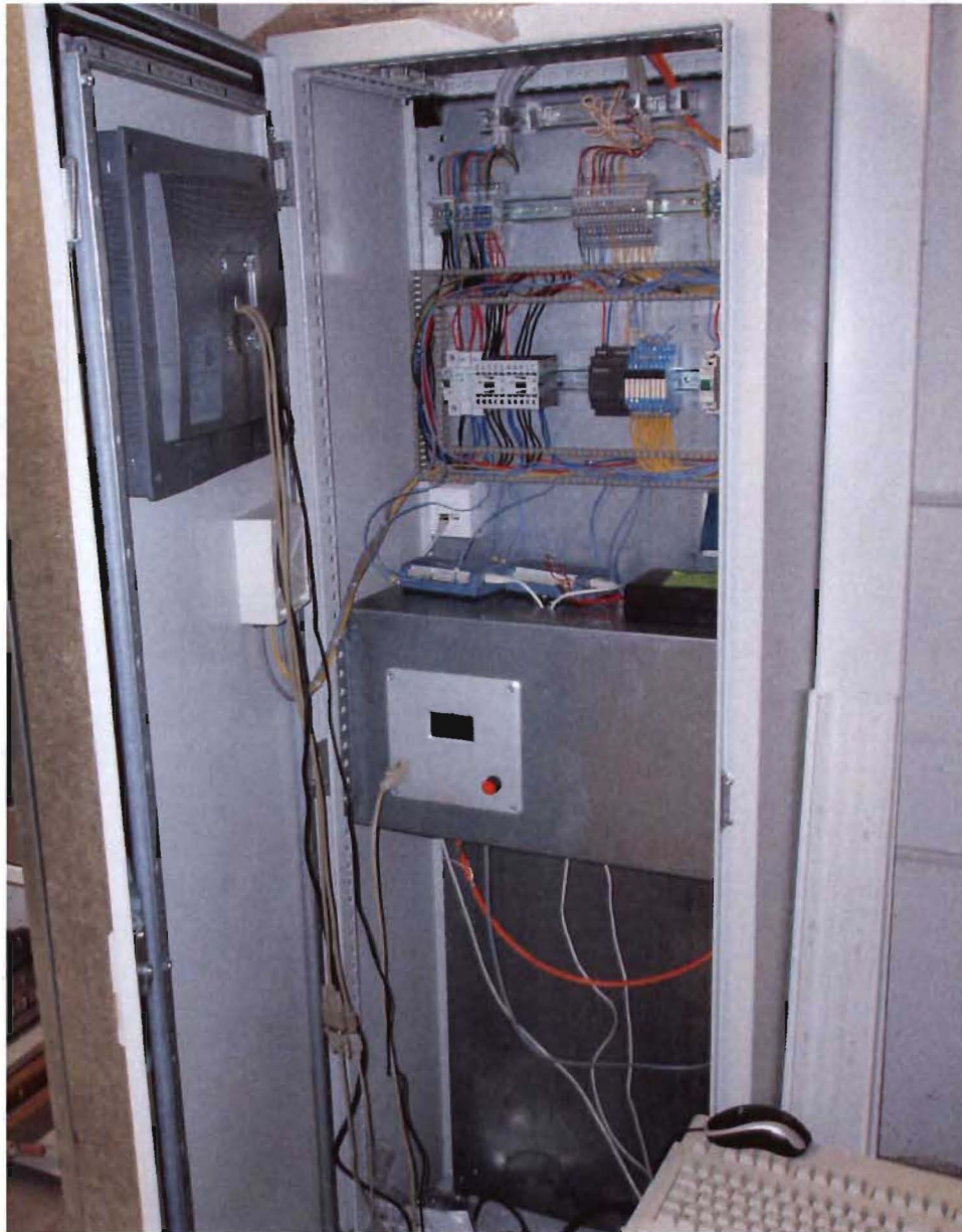
Abb. 3-3: Schaltschrank mit PC für übergeordnete Regelung.
