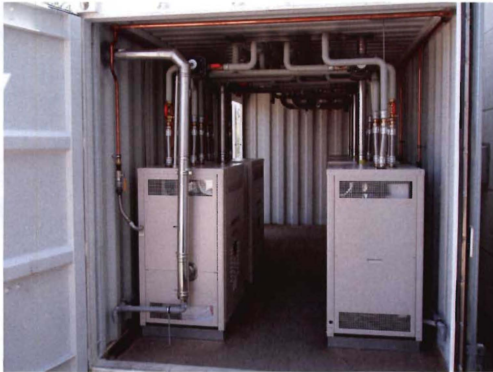
Abb. 2-1: Wärmepumpen in Seecontainer (Front geöffnet), noch ohne warmen Speichertank
