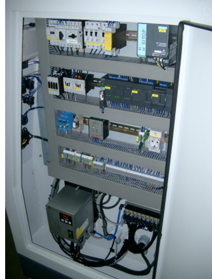
Abb. 23: Blick in der Steuerungsanlage
