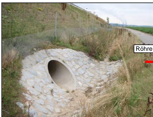
Abb. 8: (rechts): Kastendurchlass mit Erdboden
