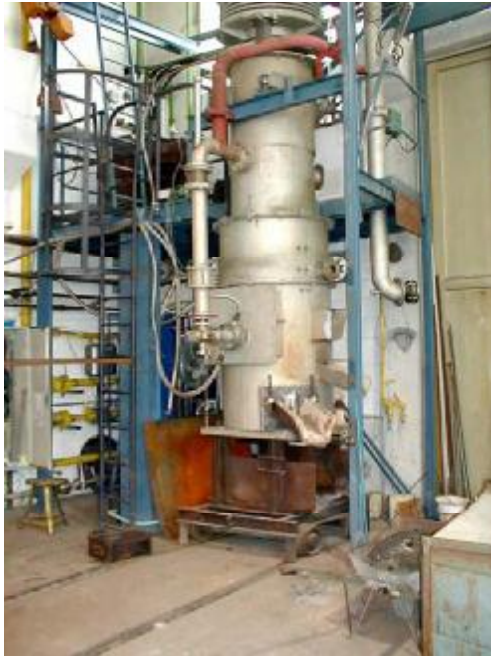
Ansicht mit Gattierungsbühne, Kreislaufgasleitung, Injektor und Abstichrinne
