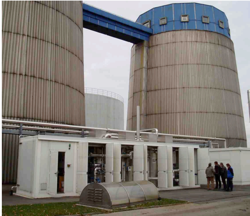
Abbildung 2-2: CAMBI-Hydrolyseanlage im Durchflussverfahren (nur für Überschussschlamm) auf der Kläranlage des Amperverbandes
