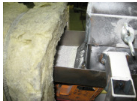
Bild 26 Aufgabebereich der Beschickungsrinne
