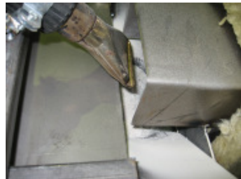
Bild 25 Heißluftvorwärmung im Aufgabebereich des Tauschers
