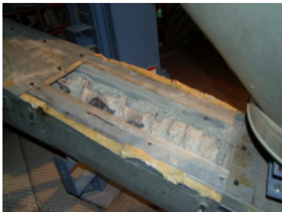
Bild 43 Überfüllung alter Transportschnecke
