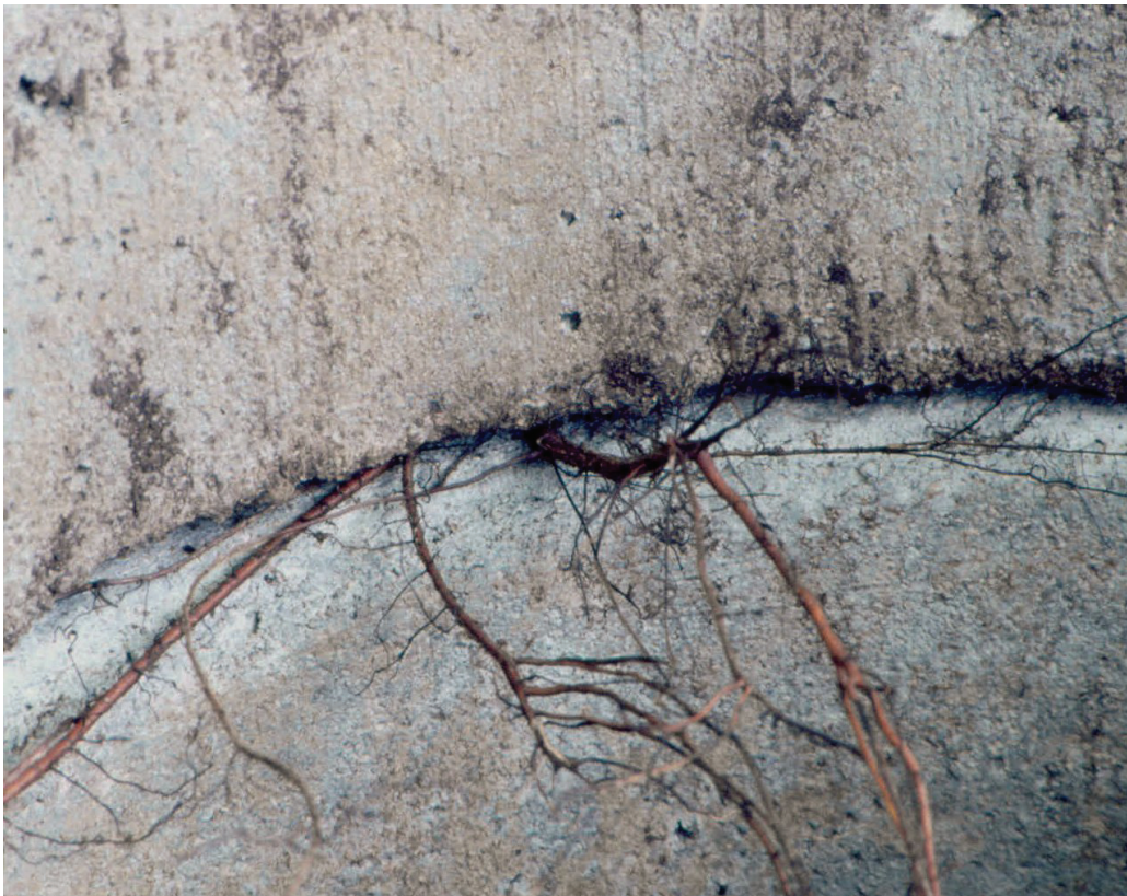
Abb. 78: Durch eine SBR-Dichtung gedrückene Wurzel von Ficus benjamina (Innenseite der Rohrverbindung)
