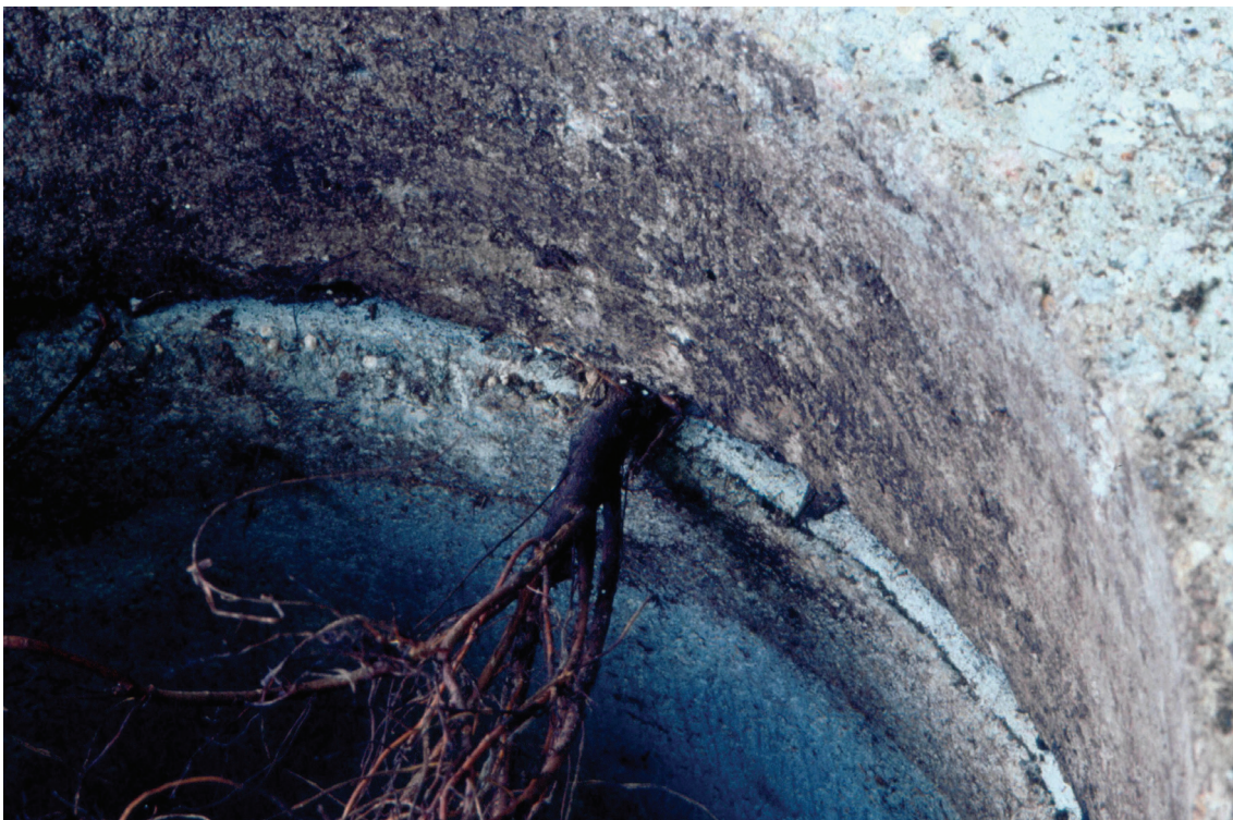
Abb. 51: Wurzeldurchdringung von Ficus benjamina (Innenseite der Rohrverbindung)
