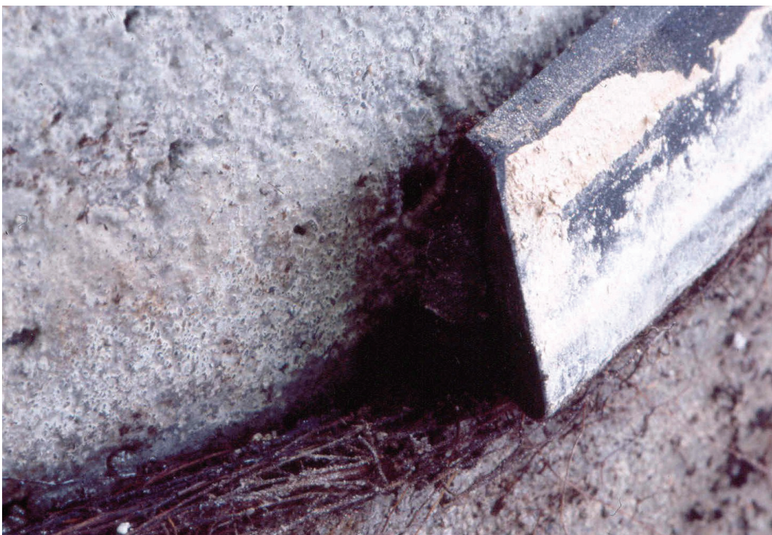
Abb. 68: Wurzeleindringungen im Bereich der Stützschulter (SBR-Dichtung, Ficus benjamina )
