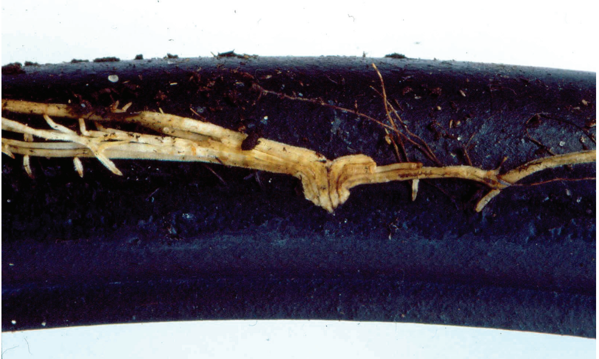
Abb. 85: Wurzeleindringungen bei der SBR-Dichtung mit 10 %iger Verpressung ( Ficus benjamina )
