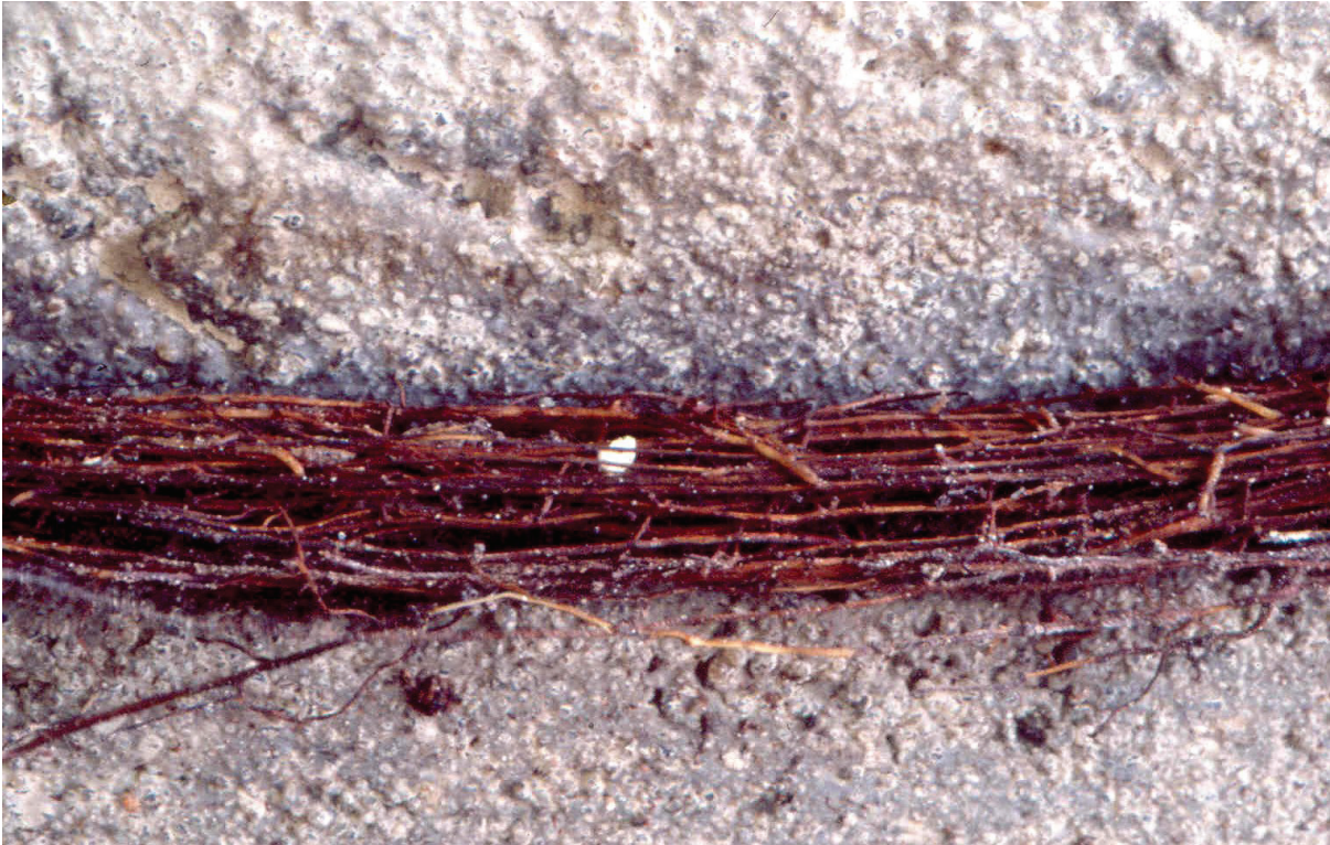
Abb. 69: Wurzeleindringungen im Bereich der Stützschulter nach Entfernen des SBR-Dichtungsringes ( Ficus benjamina )
