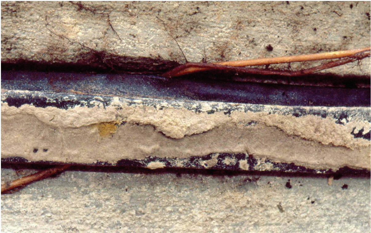
Abb. 79: Durch eine SBR-Dichtung gedrungene Wurzel von Ficus benjamina (Detail)
