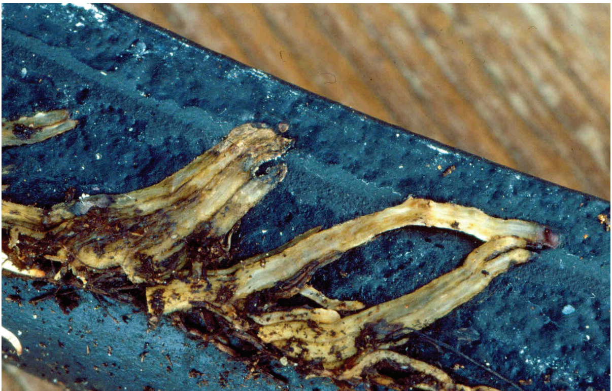
Abb. 84: Wurzeleindringungen bei der SBR-Dichtung mit 10 %iger Verpressung ( Ficus carica )
