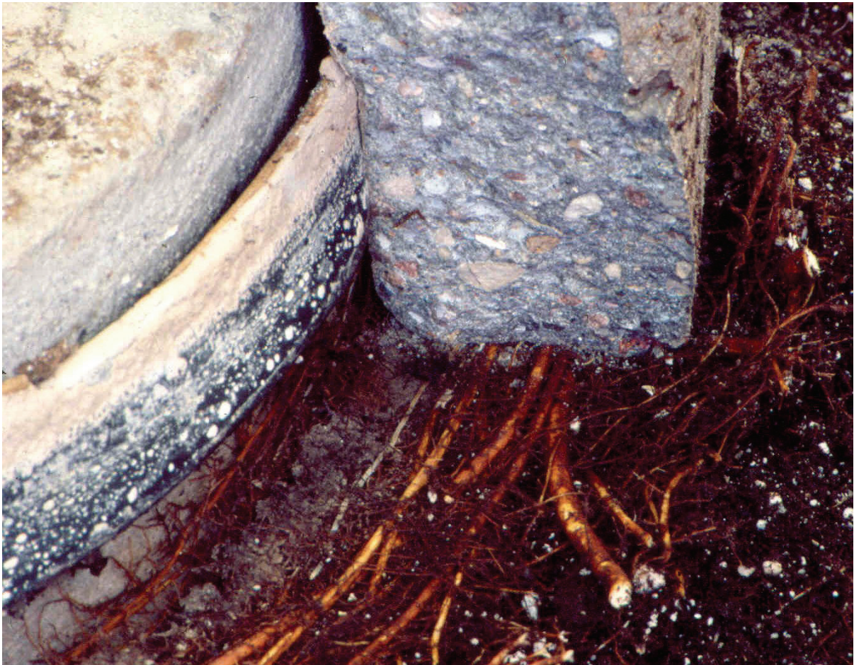
Abb. 65: Wurzeln von Ficus carica im Bereich der Dichtung
