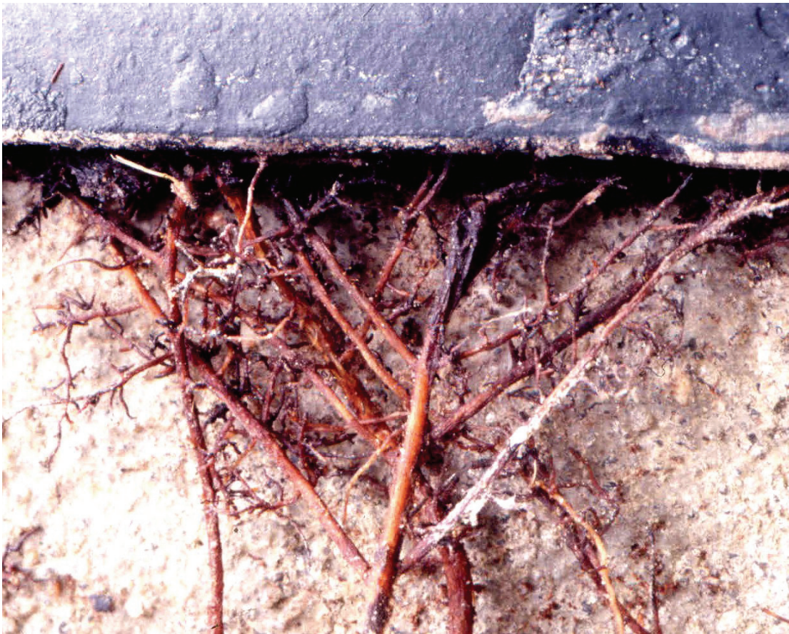
Abb. 67: Wurzeleindringungen im Bereich der Stützschulter (SBR-Dichtung, Ficus carica )
