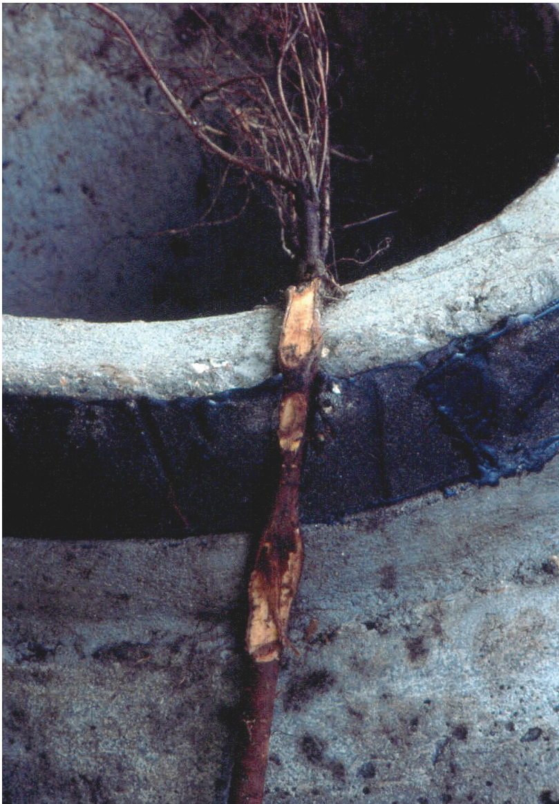
Abb. 52: Wurzeldurchdringung von Ficus benjamina (Außenseite der Rohrverbindung nach Entfernen der Muffe)
