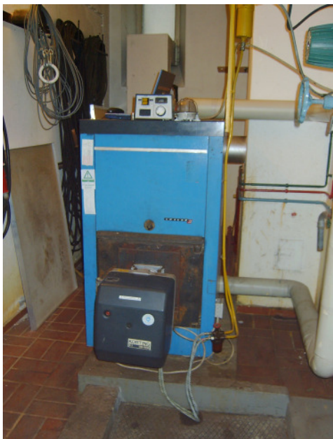
Abbildung 13 - Veraltete Kesselanlage Museum
