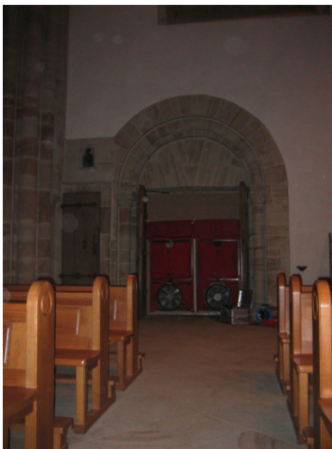
Abbildung 17 - Druckventilatoren im Kircheneingang
