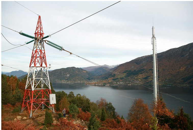
Abbildung 1: OCAS Installation in Norwegen (Quelle: OCAS)
