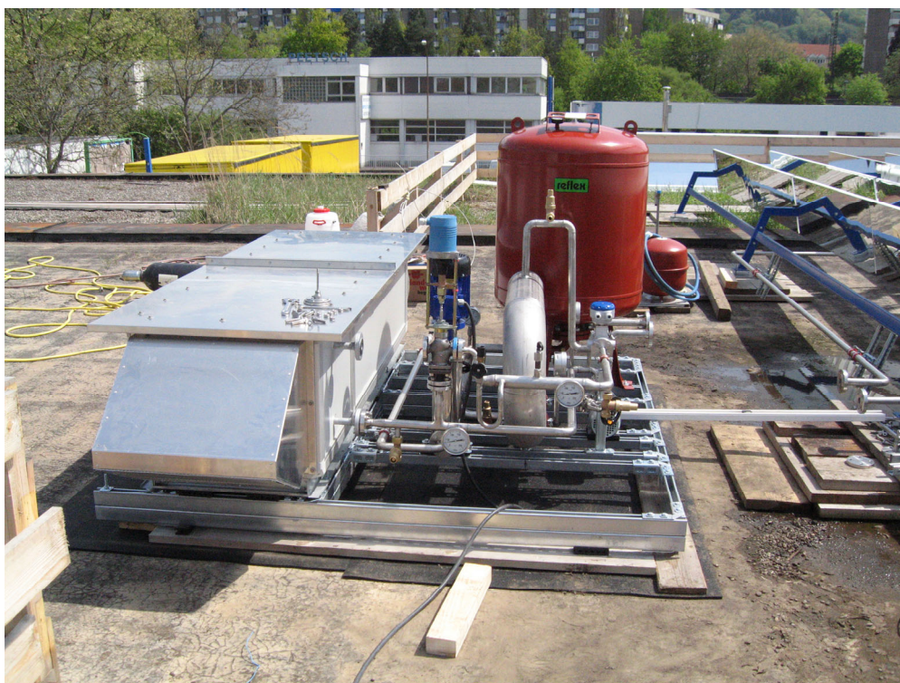
Abbildung 27: Foto: Ausdehnungsgefäß, Pumpe, Luftkühler, etc
