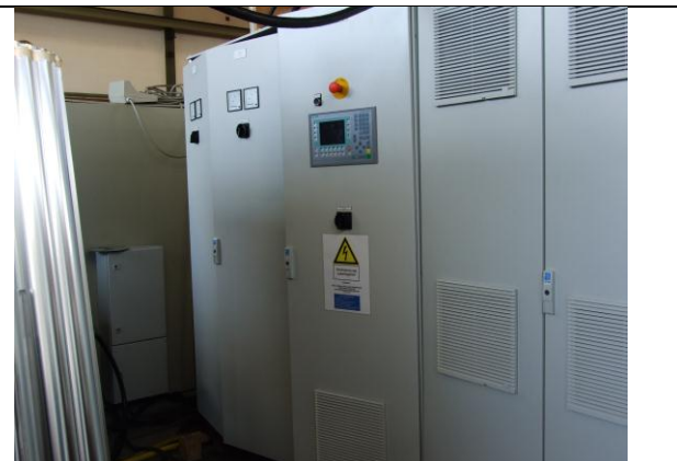
Abb. 3.14: Hochstromanlage II Dr. Laure Plasmatechnologie GmbH Leistungsdaten I = 500 \text{ A} oder I = 250 \text{ A} U = 250 \text{ V} U = 500 \text{ V}
