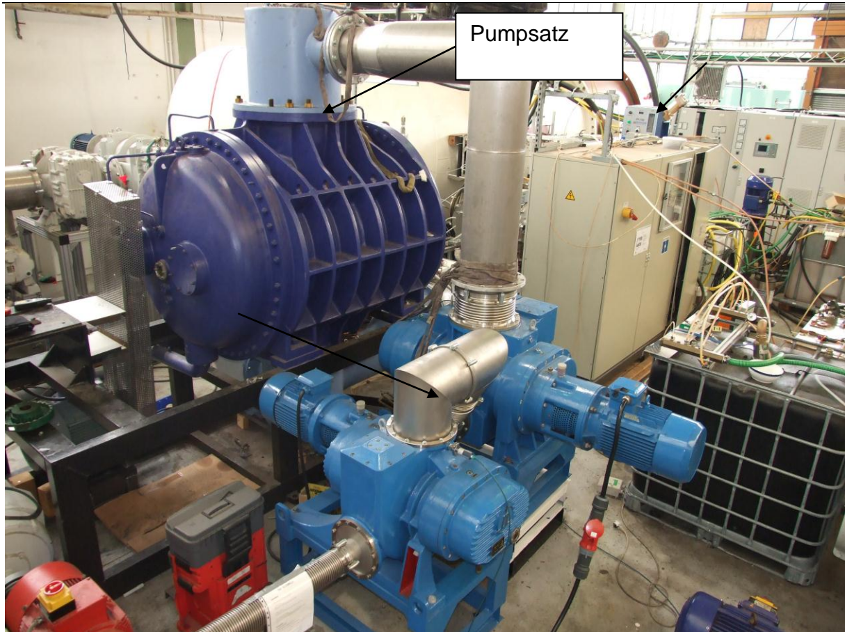
Abbildung.3.22: Vakuum-Containment, Saugleitung und Pumpsatz
