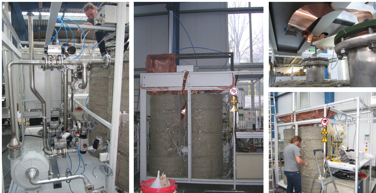
Abbildung 7 Fotos von der Pilotanlage bei der Firma Prantner in Reutlingen.
