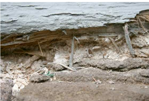
Abb. 44 Die Fußschwelle ist aufgrund langanhaltender Feuchtebelastung infolge aufsteigender Feuchte und trocknungsblockierender Farbbeschichtung durch Pilzbefall stark geschädigt. (DFWZ)
