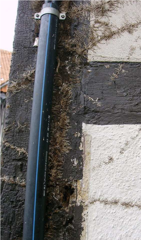
Abb. 107 Durch die Haftwurzeln von Pflanzen stark geschädigter Fachwerkstiel (DFWZ QL B)
