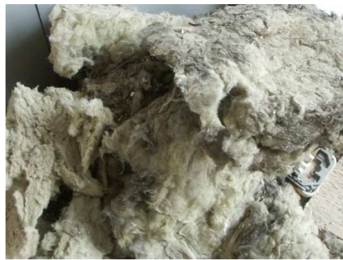
Abb. 96 feuchte Mineralwolle, ausgebaut aus einem Innendämmsystem in leichter Ständerbauweise (DFWZ QLB)
