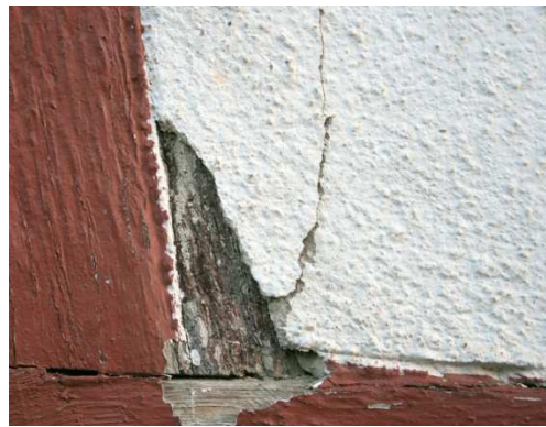
Abb. 57 Unkontrollierter Flankenabriss entlang der Anschlussfuge Fachwerkholz-Gefacheputz
