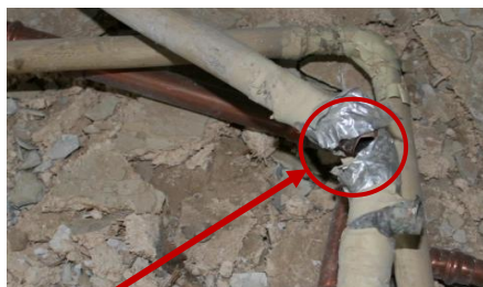
Leckage im Eckpunkt des Heizungsrohrs
