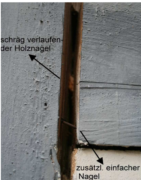
Abb. 61 In der Vergrößerung erkennt man, dass der Riegel nur mit einem Holznagel und einem einfachen Nagel an den Ständer angeschlossen wurde. (DFWZ QLB)
