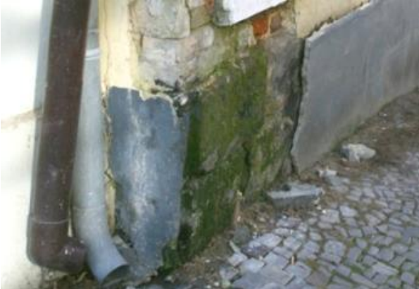
Fehlstelle im Zementputz (abgängig)
