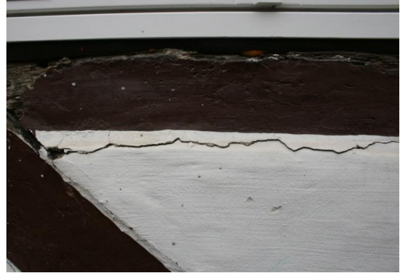
unkontrollierte Flankenabriss zwischen Gefacheputz und Fachwerkhölzern
