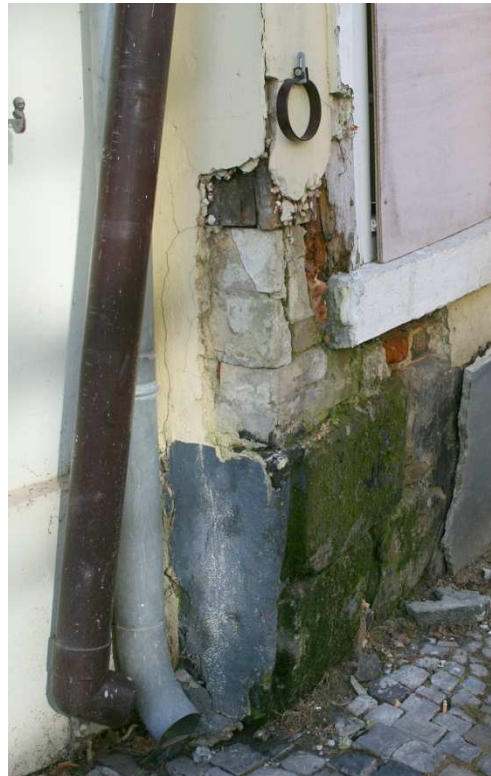
Abb. 109 Eine unterlassene Instandsetzung der Dachentwässerung begünstigte das Ausmaß der Feuchteschäden am Sockel (DFWZ QLB)
