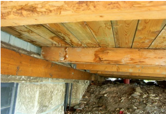
Feuchtflecken und Pilzbefall hier an der Unterseite der Rauspundlage durch undichten Balkonbelag
