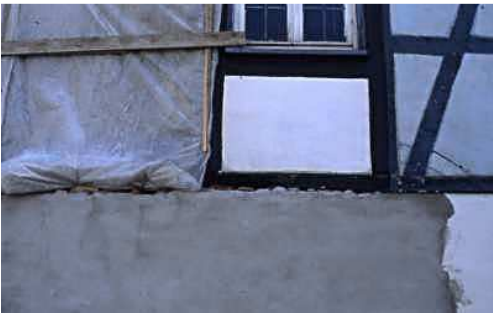
Abb. 68 Ausschnitt der geschädigten Fachwerkkonstruktion eines Wohnhauses in Arnsherg
