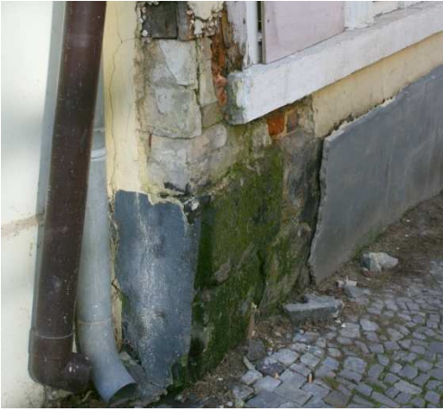
Abb. 47 Der Zementputz löst sich scheibenförmig von den Sandsteinen ab. Durch eine schadhafte Dachentwässerung wurde der Feuchteintrag zusätzlich forciert, so dass sich im Schwellholz und im aufgehenden Ständer holzerstörende Pilze ausbreiten konnten. Die Sandsteine sind mit Algen und Moosen bewachsen. (DFWZ)
