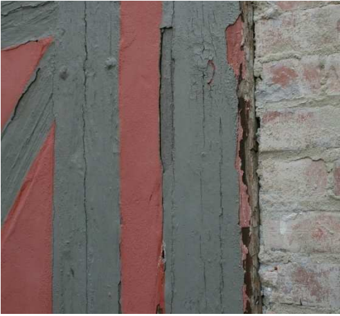
Abb. 28 Mehrfachbeschichtung der Fachwerkhölzer (erst Farbe des Gefacheanstrichs, darauf Farbe des Holzansstrichs. (DFWZ)
