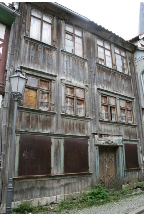
Abb. 18 nachträgliche Holzbekleidung (DFWZ)
