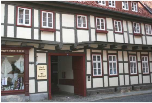
Abb. 12 Teilansicht Straßenfassade mit statisch belasteter (durchhängender) Tordurchfahrt (DFWZ)
