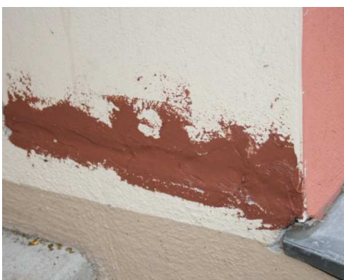
Abb. 41 Acrylhaltige Dichtmasse als provisorischer Verschluss breiter Risse in der Außenbekleidung eines Fachwerkhauses. (DFWZ QLB)
