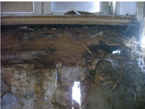
Abb. 49 Zerstörte Fachwerkhölzer und gestörtes Sockelmauerwerk vom Innenraum aus betrachtet - nach Abnahme der innenseitigen Verbretterung. (DFWZ)
