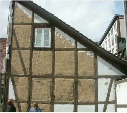
Abb. 82 Auswaschung der Lehmgefache durch fehlenden Wetterschutz der Giebelfläche und falsche Materialwahl beim Verputz. In der Regel bringt man einen Kalkputz auf Lehmsteinausfachungen auf. (DFWZ QLB)
