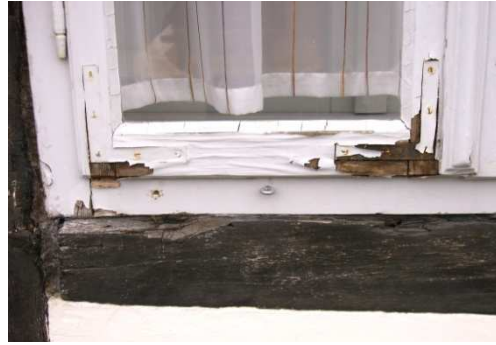
Abb. 31 Rissbildung in der Farbschicht war die Ursache für das Eindringen von Schlagregen; zusätzliche Kondensatbildung und die durch das dichte Farbsystem behinderte Abtrocknung führte zum Rosten der Beschläge einerseits sowie zur Blasenbildung und zum Absprengen der Beschichtung der Holzfenster andererseits. (DFWZ)
