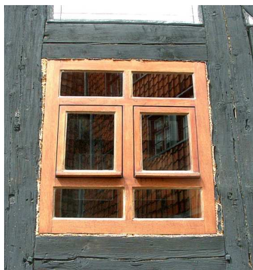
Abb. 38 ungeschützte Fugenabdichtung mit Korkfüllmasse als vorerst optischer Mangel (DFWZ QLB)
