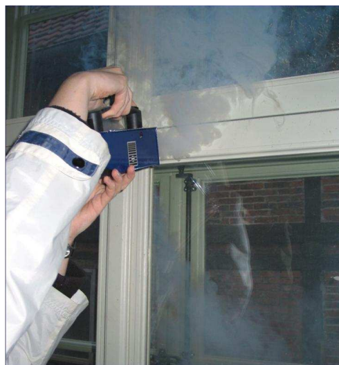
Abb. 89 Nachweis der Undichtheit auf der Innenseite des Kastenfensters, die Dichtung an den Fensterflügeln musste nachgearbeitet werden.
