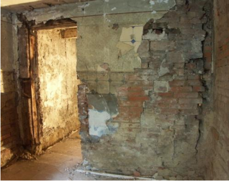
Mittig ausbauchende Ziegelsteinwand mit mehreren senkrechten Rissverläufen
