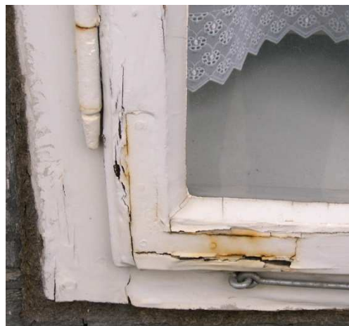
Abb. 32 Detailaufnahme des von den Beschlägen aus durchschlagenden Rostes. (DFWZ)
