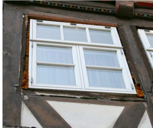
Abb. 99 Bsp. für nicht angepasste Fenstergröße und Ausfüllung der Zwischenräume mit Bauschaum (DFWZ QLB)
