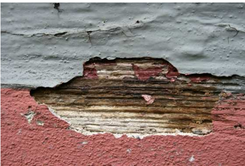
Abb. 29 Feuchtflecken auf dem Schwellholz, darunter im Bild Reste des Überputzes, oben im Bild rissiger Farbansstrich in mehreren Lagen erkennbar (DFWZ)
