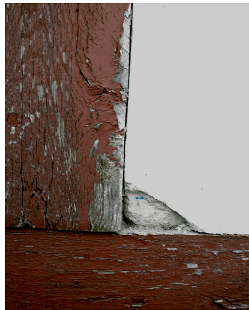
Abb. 26 Rissige und abblätternde Farbbeschichtung der Fachwerkhölzer im Erdgeschoss. (DFWZ)
