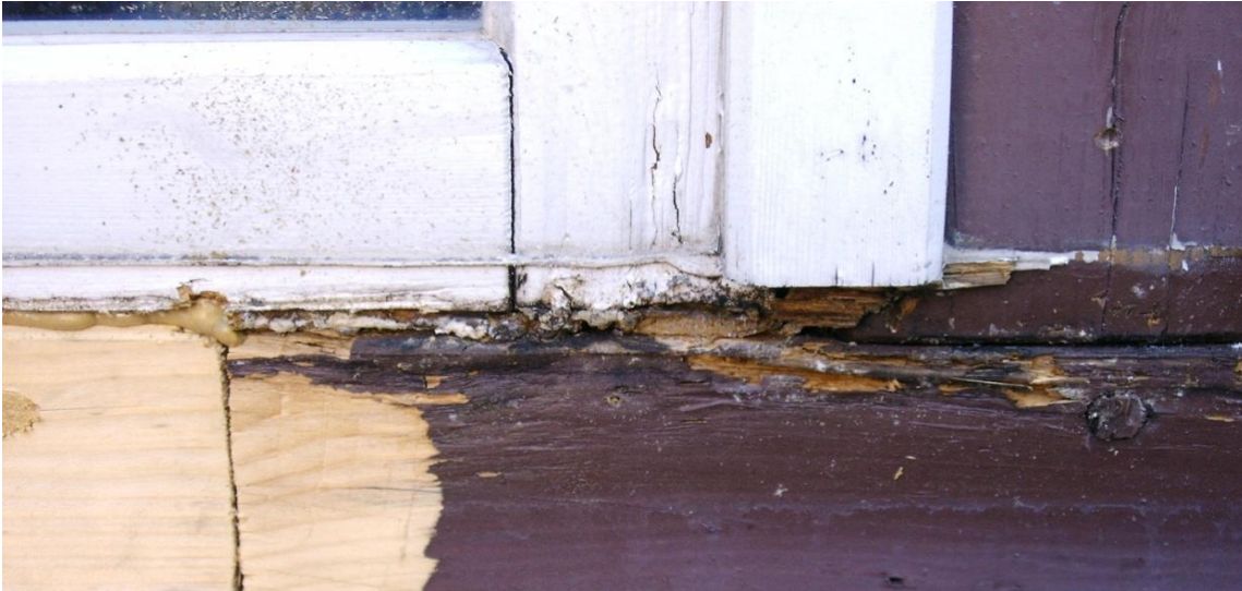
Pilzbefall an den Rahmenhölzern und dem darunter liegenden Brüstungsholz
