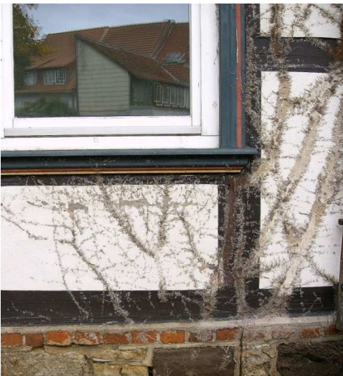
Abb. 108 Auch die Gefachoberfläche (Beschichtung und Verputz) sind durch die Haftwurzeln der Pflanzen geschädigt worden. (DFWZ QL B)
