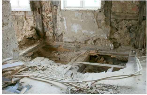
Deckendraufsicht: Bodenbelag/Füllung zurückgebaut, Schwammschäden an DB und Schwellholz
