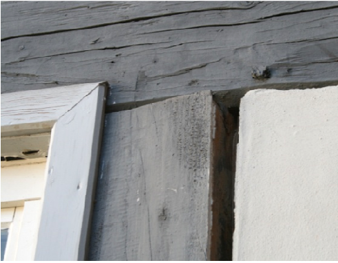
Abb. 59 Drehwuchs des Fachwerkständers rechts neben dem Fenster, sehr breite Fuge zum Gefach, Abriss der Fensterabdichtung außen (DFWZ QLB)
