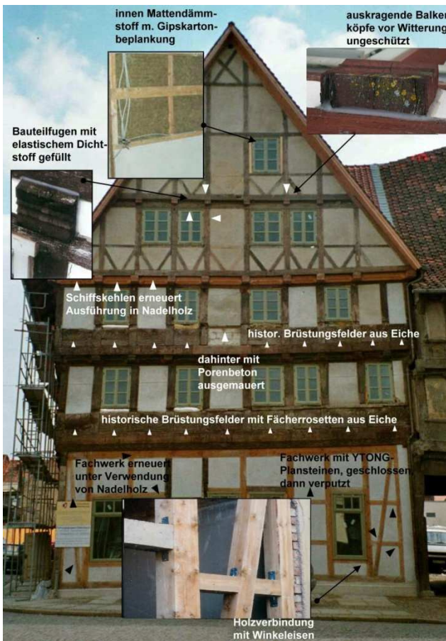
Abb. 74 Ansicht des Giebels während der Bauzeit 1995 (Foto: privat, Bauherr, bearbeitet DFWZ QLB)
