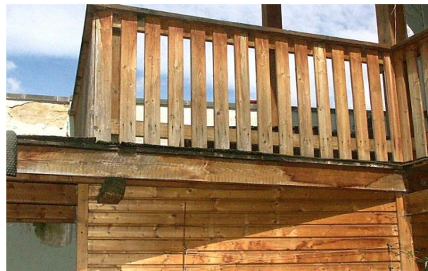
Feuchteschäden und Bemoosung an den Konstruktionshölzern und der Verbretterung des Unterbaus
