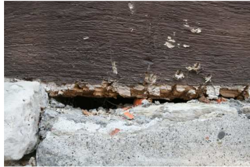
Abb. 45 Pilzbefall eines Schwellholzes, welches mit dem nachträglichen Verputz des Sockels mit angeputzt wurde. (DFWZ)
