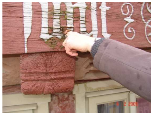
Abb. 77 Ein Finger kann leicht in die morsche Schwelle hinein gedrückt werden. (Schadensgutachten B. Müller [59] )
