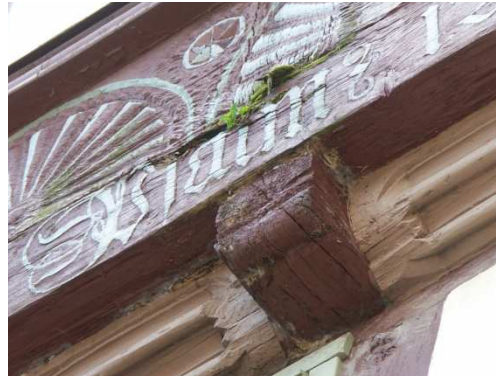
Abb. 76 Pilzbefall an Balkenköpfen und angrenzenden Schiffskehlen und Stockwerksschwellen (DFWZ QLB)
