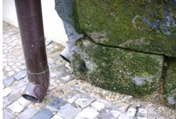
Algen- und Moosbildung am durchfeuchteten Sandsteinsockel
