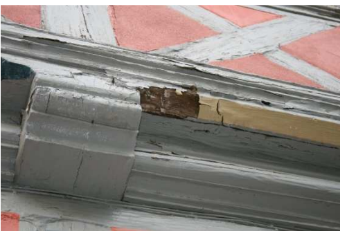
Abb. 30 Auch in den Bereichen der Stockwerksüberstände erkennt man die Rissbildung und das Abplatzen der Farbe. (DFWZ)
