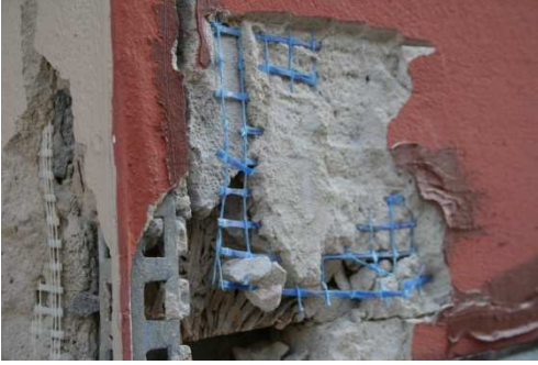
Abb. 97 Die Gewebeeinlage in der Putzschicht endet ca. 2 cm vor der Außenecke und wird nicht herumgeführt. Das Eckprofil ist nicht systemkonform und wurde nur unzureichend am Untergrund befestigt. (DFWZ QL B)
