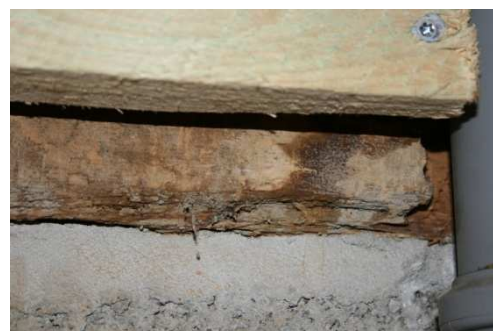
Abb. 27 Feuchtflecken und beginnende Schimmelpilzbildung an der Innenseite der Fachwerkstruktur. (DFWZ)
