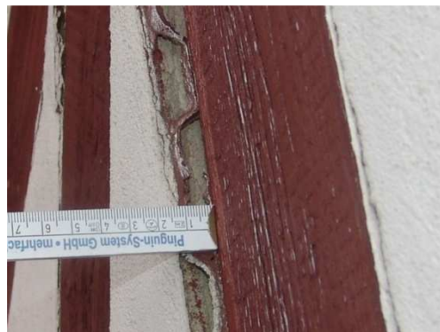
Abb. 81 Herausdrücken der Gefachebene um bis zu 1,5 cm (aus: Schadensgutachten B. Müller [63] )
