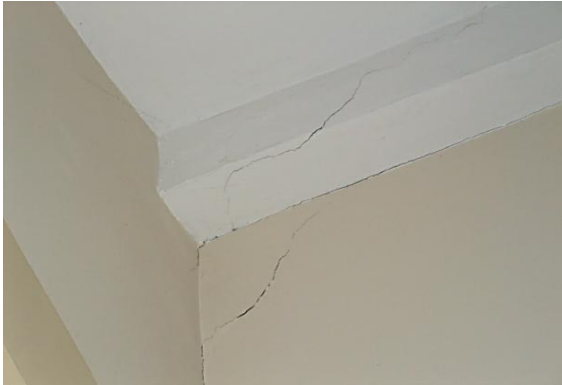
Rissbildung am Innenputz der in die Straßenfassade einbindenden Innenwände im oberen Wandbereich
