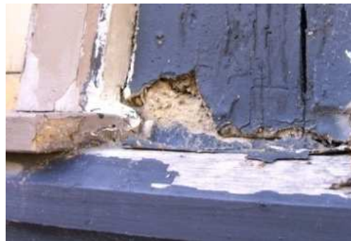
Abb. 37 Feuchteschäden im Brüstungsbereich konstruktiv bedingt, durch Spachtelmasse verstärkt (DFWZ QLB)
