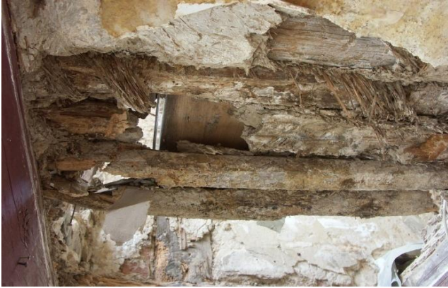
Deckenuntersicht: Bruch der Deckenbalken, Schwammschäden an Balken und Lehmwickeln
