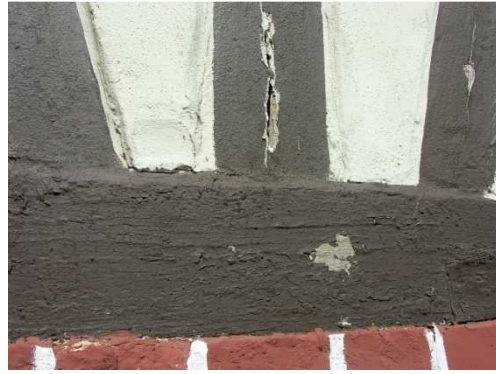
Abb. 21 Der Farbanstrich über Fachwerkhölzern und Gefacheputz zeigt Blasenbildung, Risse und Abplatzungen. (DFWZ)
