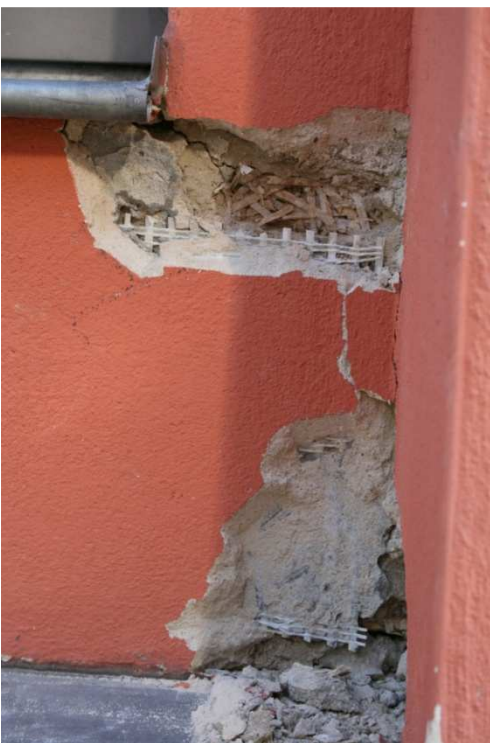
Abb. 98 Auch hier ist erkennbar, dass die Gewebeeinlage nicht um die Innenecke herumgeführt wird. Die Einlage endet bis zu 3 cm vor dem Fenster- bzw. Sockelanschluss und wurde auch seitlich des Fensters nicht in Höhe verlegt. (DFWZ QL B)
