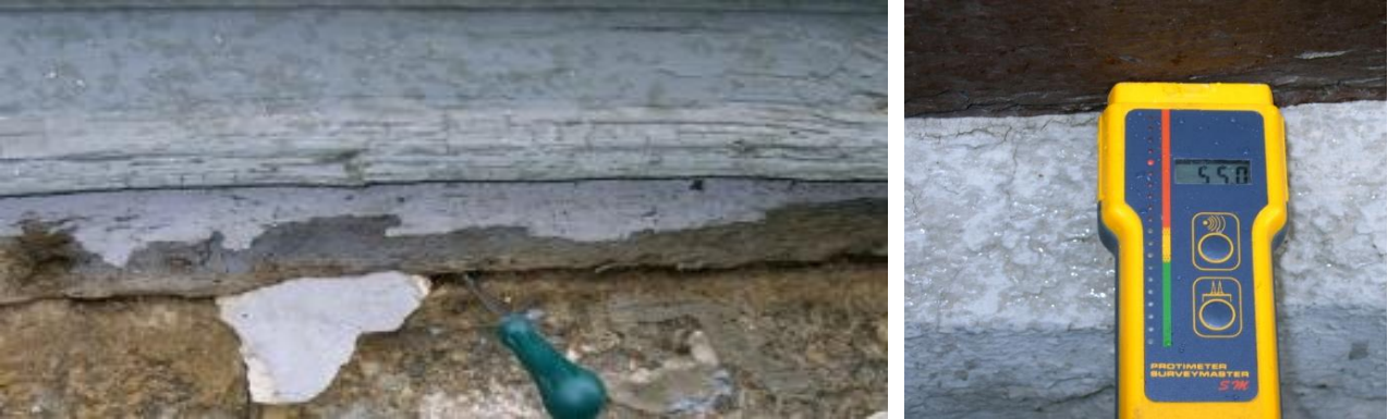
Pilzbefall und Feuchtestau an den Schwellhölzern im Erdgeschoss (links) gemessene Holzfeuchte 55 Masseprozent (rechts)
