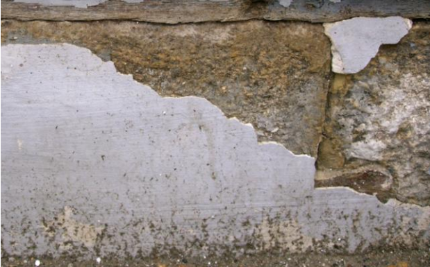
abplatzender Zementputz vom Sandsteinsockel,
