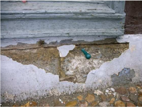
Abb. 42 Der nachträgliche Zementverputz löst sich großflächig vom Sandsteinsockel und führte zu Pilzbefall an der aufliegenden Schwelle. Ein Stechbeitel lässt sich mühelos in das Holz schieben. (DFWZ)
