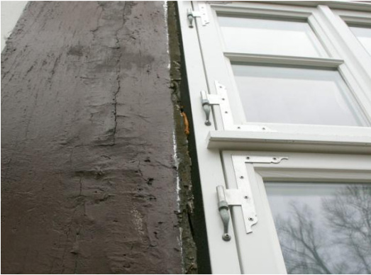
Versprödung und Rissbildung am Fachwerkständer
