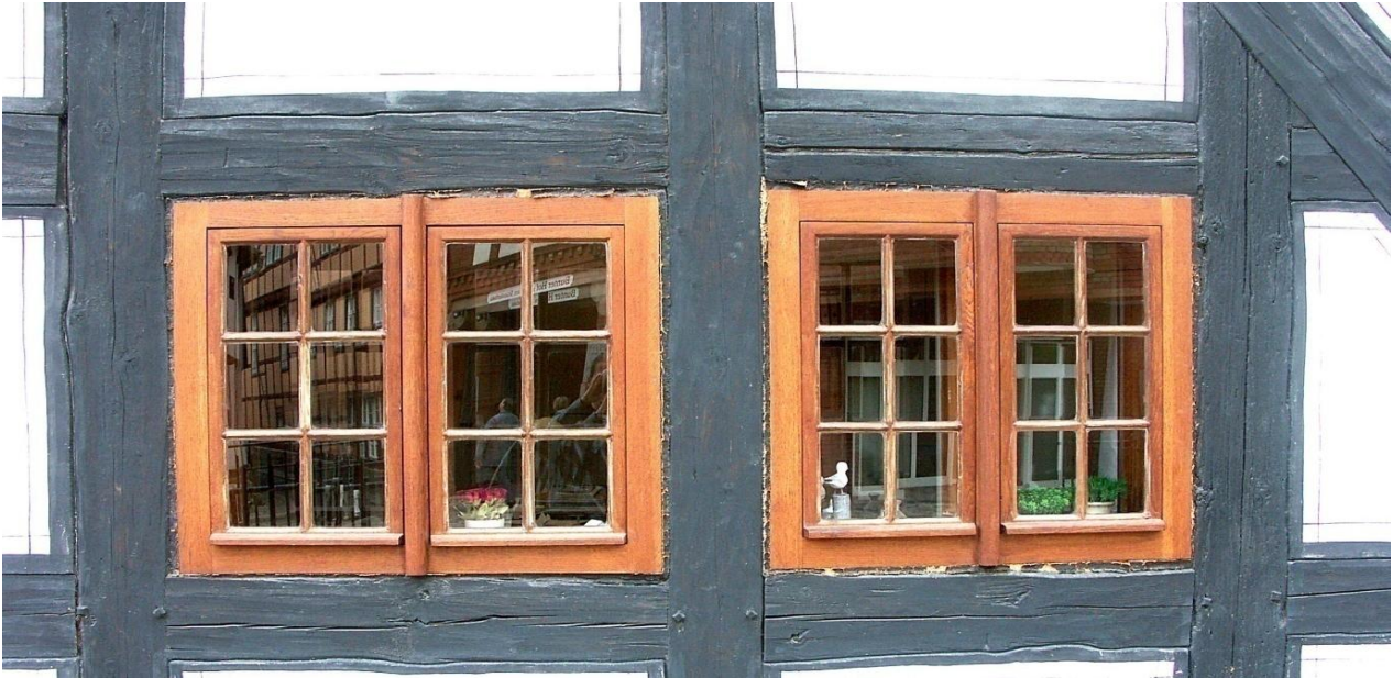
Versprödung und Verwitterung der Korkfüllmasse in Fensteranschlussfugen
