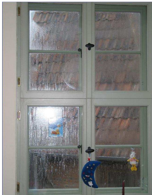
Abb. 88 Erheblicher Ausfall von Kondensat auf der Innenseite des äußeren Fensterglases infolge noch vorhandener Baufeuchte.
