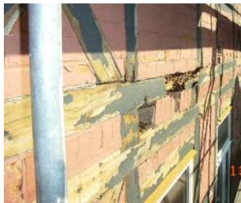
Abb. 22 Abplatzungen des Farbanstrichs über Fachwerkhölzern und Gefacheausmauerung, Zerstörung der Fachwerkhölzer durch Pilzbefall, hier an der Westseite des zweiten Gebäudes (privat, Holzschutzgutachter)
