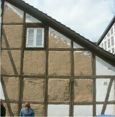
Abblätternder Kalkanstrich, Risse und Abplatzen des Lehmputzes
