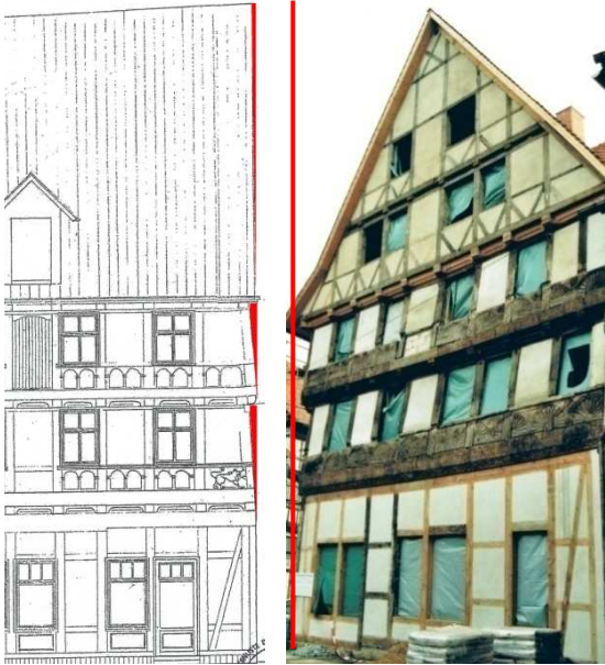
Abb. 72 und 73 Die roten Linien verdeutlichen in der Bestandszeichnung (links) und dem Ausführungsfoto (rechts) die Schiefstellung des Westgiebels
