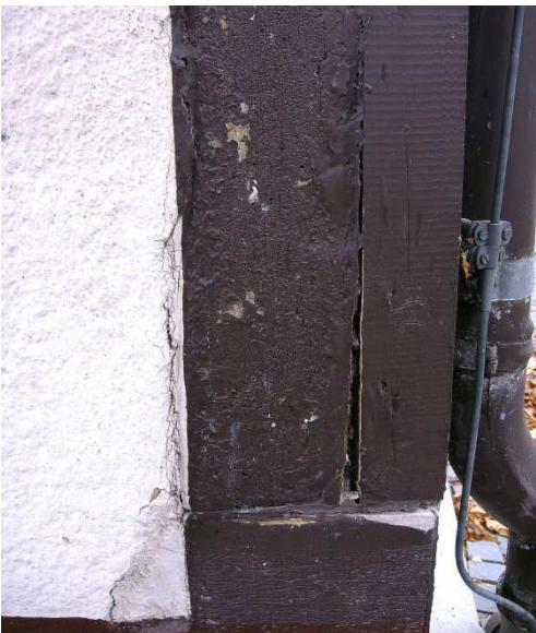
Abb. 34 Durch die Vergrößerung des Risses ist die Fugenmasse von den Flanken abgerissen. Feuchtigkeit stauete sich im Inneren des Holzes. (DFWZ QLB)
