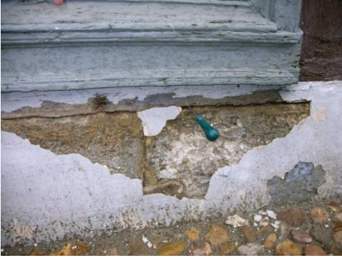
Abb. 42 Der nachträgliche Zementverputz löst sich großflächig vom Sandsteinsockel und führte zu Pilzbefall an der aufliegenden Schwelle. Ein Stechbeitel lässt sich mühelos in das Holz schieben. (DFWZ)
