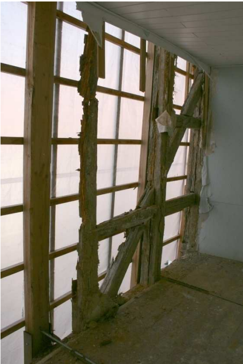
Abb. 87 Reste des eingestürzten Westgiebels von innen im 2. Obergeschoss (DFWZ QLB)
