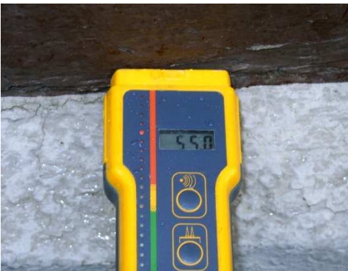
Abb. 43 Die im Schwellholz gemessene Holzfeuchte betrug 55 Masseprozent und deutet auf einen schon längere Zeit anhaltenden Feuchtestau, begünstigt durch den trocknungsblockierenden Farbanstrich. (DFWZ)
