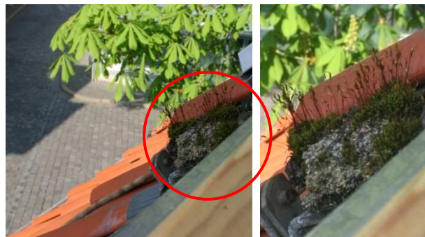
Abb. 111 Die Bemoosung am unteren Anschluss des Dachflächenfensters sollte entfernt werden. (DFWZ QLB)
