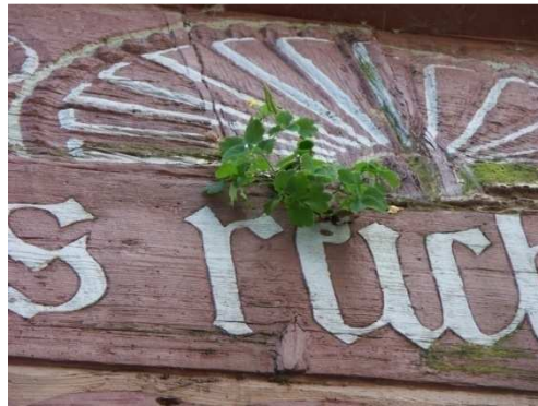
Abb. 75 Pflanzenbewuchs an den beschnitzten Brüstungsbohlen (DFWZ QLB)
