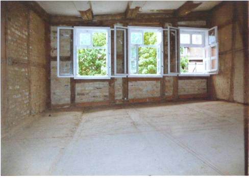
Abb. 19 Fußbodengefälle in einem Fachwerkbau (DFWZ)
