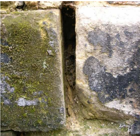
Abb. 48 Auch die Mörtelfugen des Sandsteinmauerwerks wurden heraus gespült. (DFWZ)
