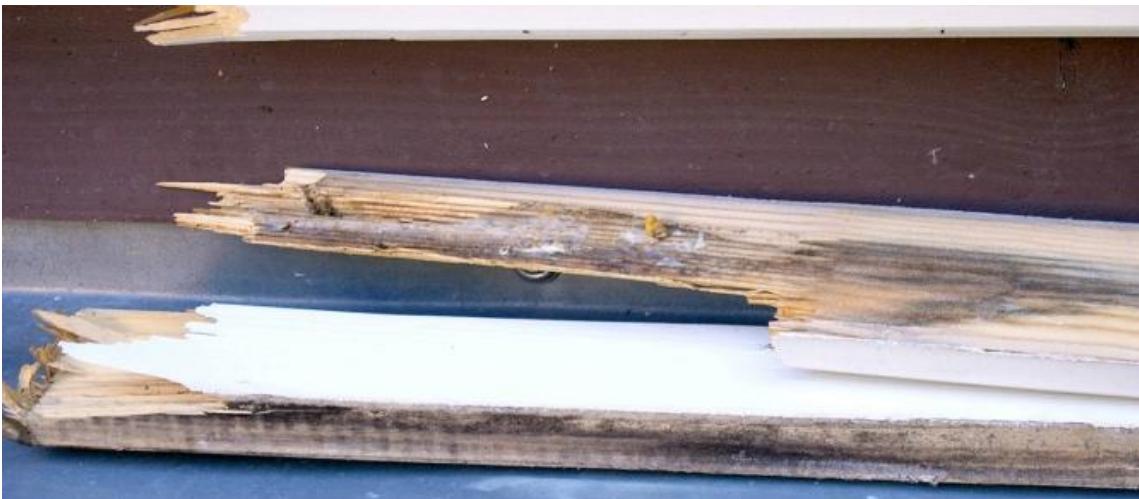
Schimmelpilzbefall an und in den Rahmenhölzern
