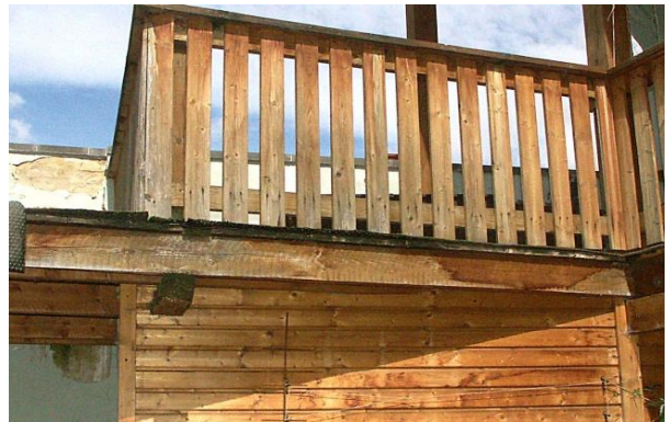
Feuchtschäden und Bemoosung an den Konstruktionshölzern und der Verbretterung des Unterbaus
