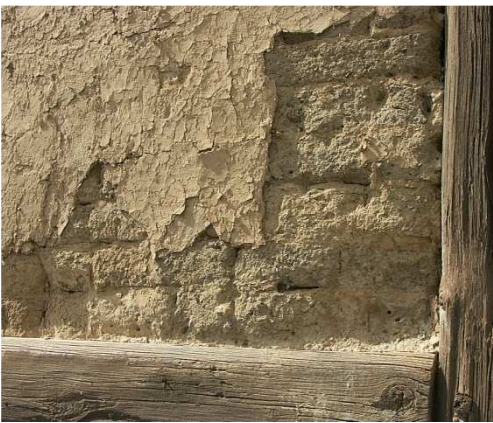
Abb. 83 Zerstörung des Lehmverputzes und der Lehmziegelausfachung durch Witterungseinflüsse (DFWZ QLB)
