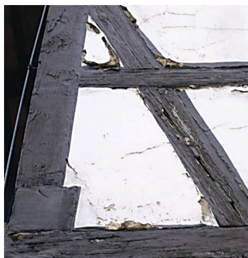
Abb. 55 Übermäßig durchfeuchtete Lehmputze und Fachwerkhölzer führten zum Herausdrücken des Putzes (DFWZ QLB)
