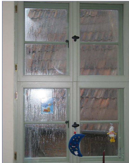
Abb. 88 Erheblicher Ausfall von Kondensat auf der Innenseite des äußeren Fensterglases infolge noch vorhandener Baufeuchte.
