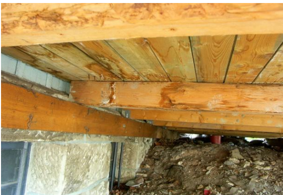
Feuchtflecken und Pilzbefall hier an der Unterseite der Rauspundlage durch undichten Balkonbelag
