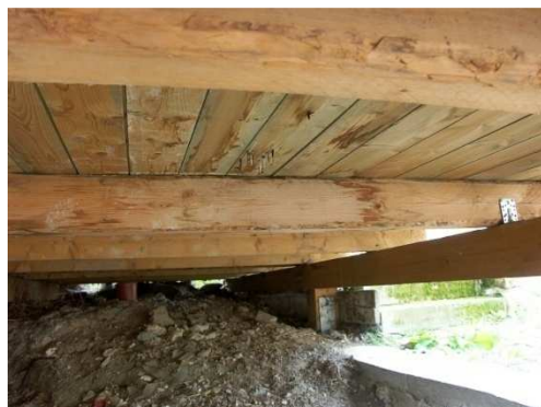
Abb. 92 Balkonunterseite: Traghölzer und Rauspund mit Feuchte- und Fäulnisflecken, zu geringe Querschnitte
