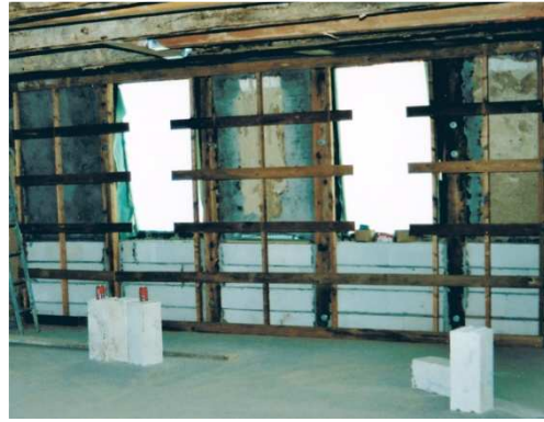
Abb. 80 Die Innenansicht während der Bauphase zeigt Ytong-Plansteine als Gefachfüllung im Brüstungsbereich, darüber liegende Gefache behielten vermutlich die historische Gefachfüllung, (Foto: privat, Bauherr)
