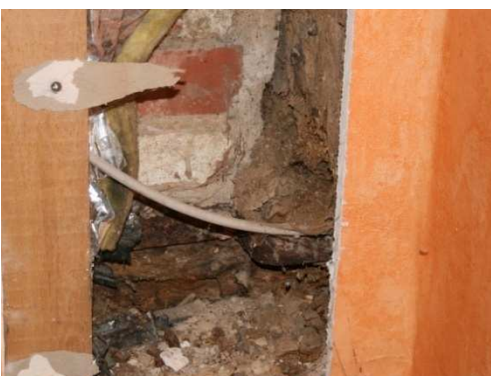
Abb. 35 Bei der Öffnung der inneren Vorsatzschale wurden die Zerstörung des Stiels und der Fußschwelle durch Pilzbefall deutlich. (DFWZ QLB)
