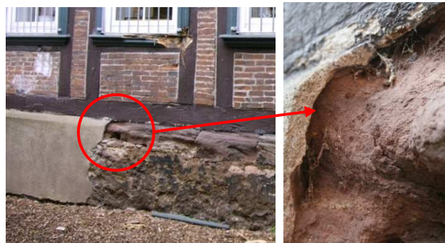
Abb. 46 Bei dem nachträglich mit einem Zementputz versehenen Sockelmauerwerk aus Naturstein löst sich die Putzschale großflächig. Das darunter liegende Natursteinmauerwerk ist durchfeuchtet und in seiner Festigkeit geschwächt. Aufsteigende Feuchte verursacht die Durchfeuchtung - ein dichter Farbauftrag begünstigt den Feuchtestau der Schwellhölzer (DFWZ)
