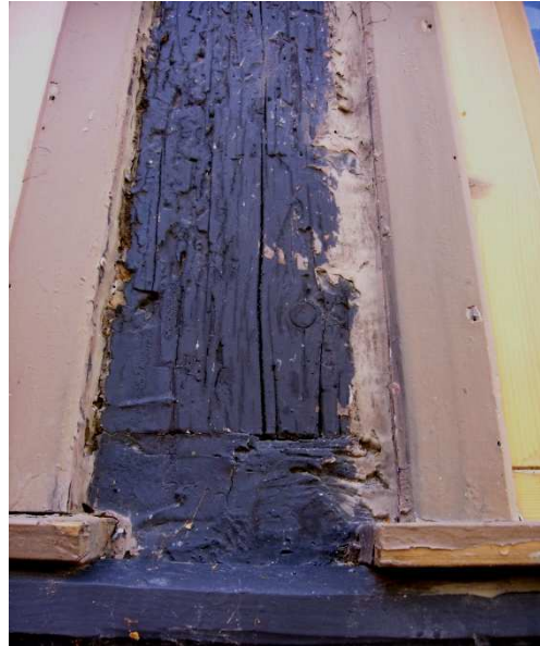
Abb. 36 Trocknungsblockierende Spachtelmasse als Fugenfüllstoff verursacht bzw. fördert Feuchteschäden an den angrenzenden Hölzern. (DFWZ QLB)
