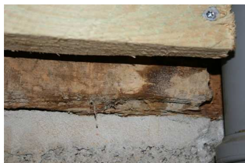
Abb. 27 Feuchtflecken und beginnende Schimmelpilzbildung an der Innenseite der Fachwerkkonstruktion. (DFWZ)
