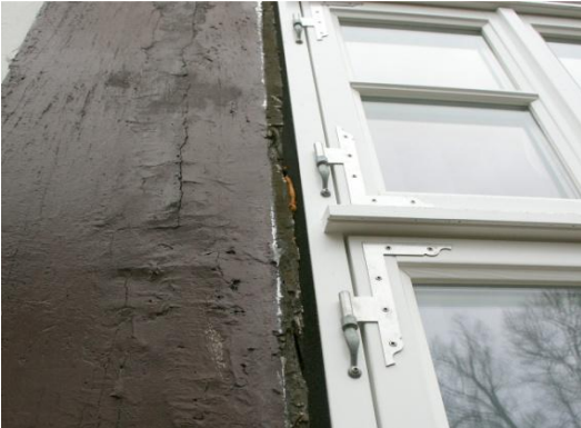
Versprödung und Rissbildung am Fachwerkständer
