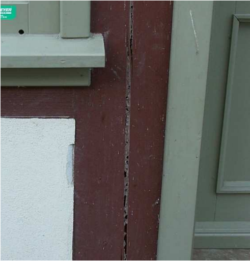
Abb. 33 abgerissene Silikonfuge in einem Trocknungsrisse (DFWZ QLB)
