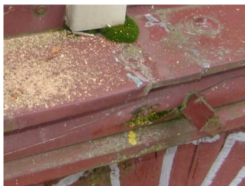
Abb. 78 Algen und Moos an der Blechabdeckung und den Holzgesimsen (aus: Schadensgutachten B. Müller [59] )
