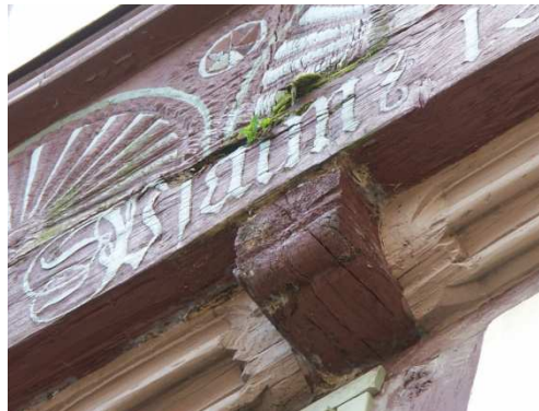
Abb. 76 Pilzbefall an Balkenköpfen und angrenzenden Schiffskehlen und Stockwerksschwellen (DFWZ QLB)
