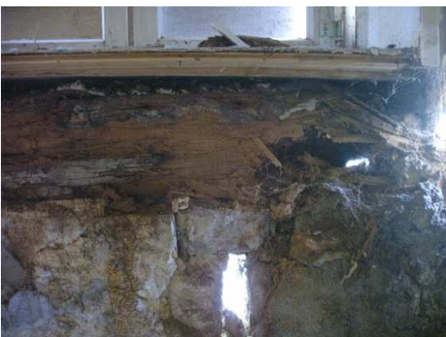
Abb. 49 Zerstörte Fachwerkhölzer und gestörtes Sockelmauerwerk vom Innenraum aus betrachtet - nach Abnahme der innenseitigen Verbretterung. (DFWZ)
