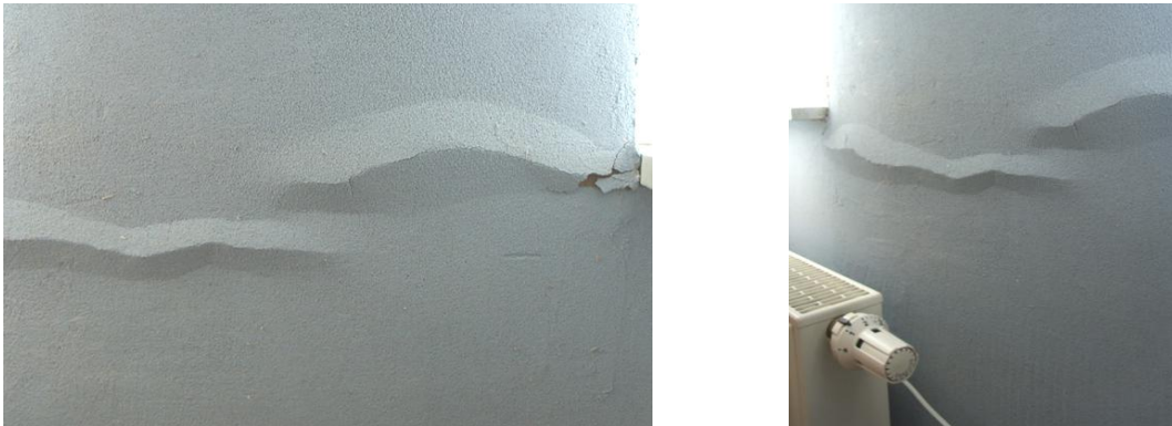
Links und rechts in Höhe der Fensterbrüstung zeigen sich Quetschrisse am Innenputz
