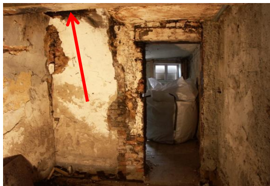
Rückseite der geschädigten Ziegelwand mit Kaminöffnung im Deckenbereich
