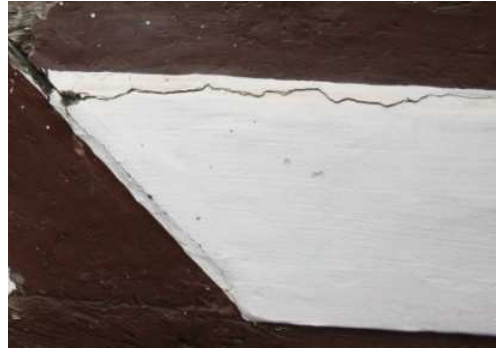
Abb. 56 Unkontrollierter Flankenabriss entlang der Anschlussfuge Fachwerkholz-Gefacheputz (DFWZ QLB)
