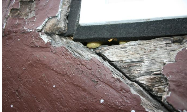
zusätzl. Abplatzen des Holzanstrichs und Feuchteschäden an den Holzoberflächen
