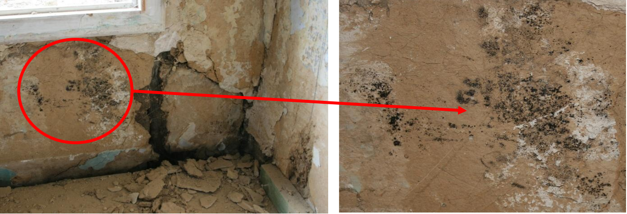
Schimmelnester am raumseitigen Lehmverputz, nach Abnahme der Vorsatzschale erkennbar
