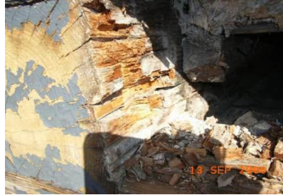
Zerstörung der Saumschwelle durch Braunfäule, Nassfäule und Weißfäule
