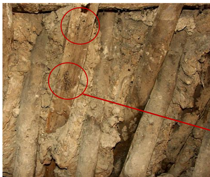
Deutlich sichtbare Feuchtflecken und Nester von Schimmel an den Holzstaken
