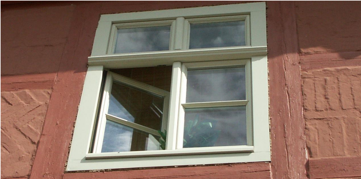
Versprödung und Verwitterung der Korkfüllmasse in Fensteranschlussfugen
