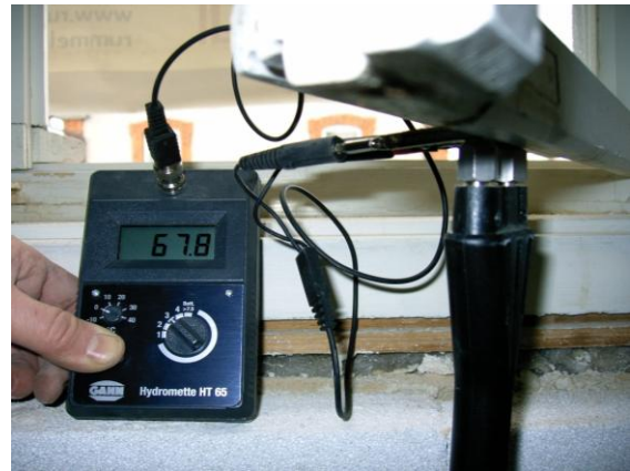
Holzfeuchte in Fensterflügeln bei 67,8 Masseprozent
