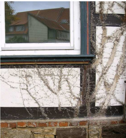
Abb. 108 Auch die Gefachoberfläche (Beschichtung und Verputz) sind durch die Haftwurzeln der Pflanzen geschädigt worden. (DFWZ QL B)
