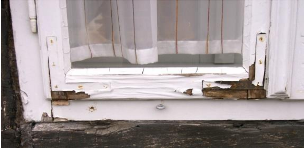
Reißen, Ausbeulen und Abplatzen der Farbbeschichtung der Fenster außen, Feuchtflecken auf dem Rahmenholz
