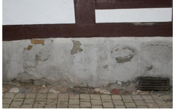
Feuchtflecken und abplatzender Zementputz vom Sandsteinsockel
