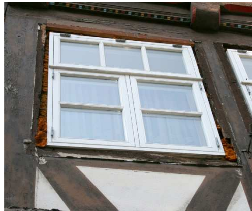
Abb. 99 Bsp. für nicht angepasste Fenstergröße und Ausfüllung der Zwischenräume mit Bauschaum (DFWZ QLB)
