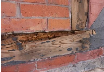
Abblätternde Farbe, Holzschäden am Schwellholz
