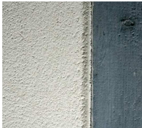
Abb. 58 Durch die fachgerecht angelegte Sollbruchstelle entlang der Anschlussfuge Fachwerkholz-Gefacheputz kam es in diesem Beispiel zu keinem unkontrollierten Flankenabriss (DFWZ QLB)
