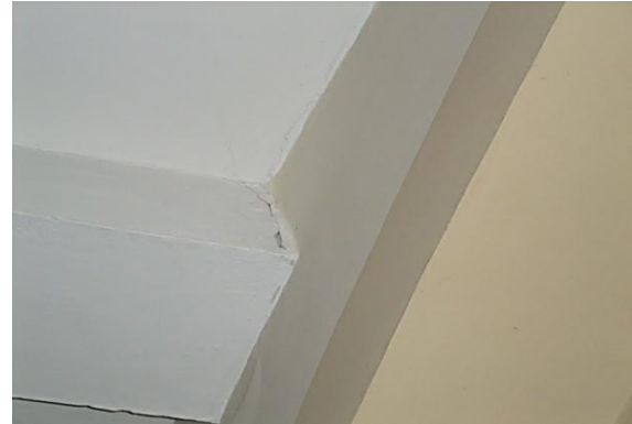
Rissbildung am Verputz der Holzbalkendecken an der Einbindung zur Straßenfassade
