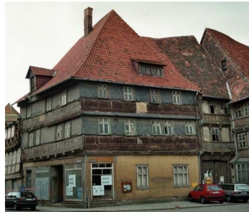
Abb. 70 Schieferbekleidung im Erdgeschoss und über den Brüstungsbohlen der oberen Stockwerke zurückgebaut, Westgiebel noch abgewalmt (Foto: Stadtmuseum Osterwieck)
