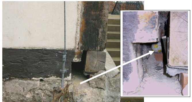
Abb. 100 mangelhafte Eckverbindung der Schwellhölzer und des aufgehenden Ständers (DFWZ QLB)
