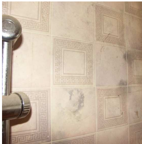
Abb. 105 Schimmelflecken unter einer folienbeschichteten Tapete in einem Duschaum (DFWZ QLB)
