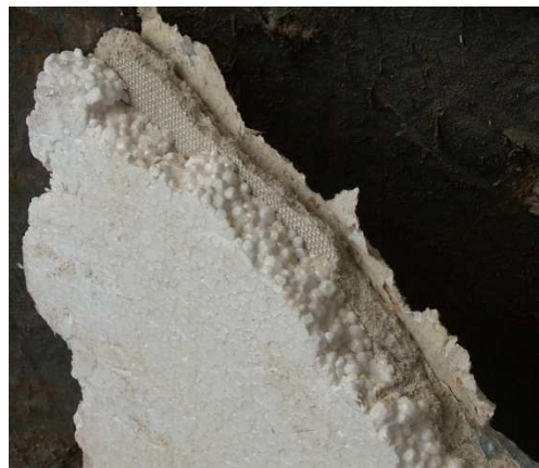
Abb. 85 Verbundplatte aus Styropor und Gipsfaser, welche als nachträgliche Innendämmung an den Außenwänden verwendet wurde. (DFWZ QLB)
