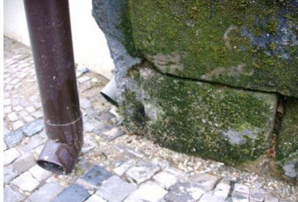
Algen- und Moosbildung am durchfeuchteten Sandsteinsockel
