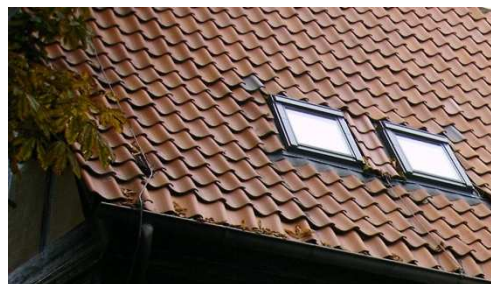
Abb. 110 Die Reinigung der Dachentwässerungsanlagen und Überprüfung der Dacheindeckung sollten regelmäßig erfolgen. (DFWZ QLB)
