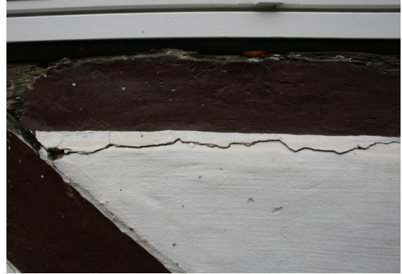
unkontrollierte Flankenabriss zwischen Gefacheputz und Fachwerkhölzern
