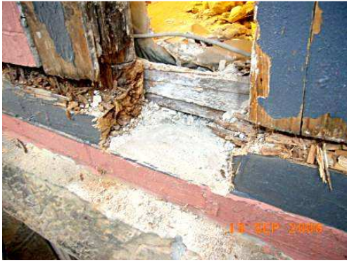
Abb. 24 Geöffneter Wandaufbau am zweiten Gebäude, deutlich erkennbar die starke Zerstörung der Schwellhölzer und aufgehenden Ständer durch Braun- und Weißfäule. Im Hintergrund ist die Glasfaserdämmschicht zu sehen. (privat, Holzschutzgutachter)
