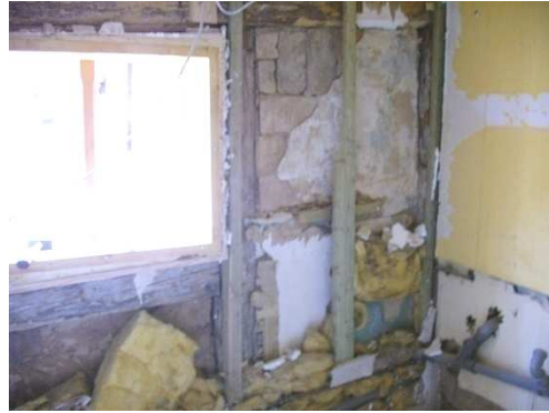
Abb. 95 Reste einer typische Innendämmung in leichter Ständerbauweise (DFWZ QLB)
