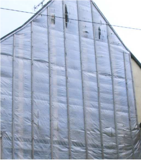
Abb. 86 Mit Baufolie vor Witterungseinflüssen geschützter Giebel, 5 Jahre nach dem Einsturz (DFWZ QLB)
