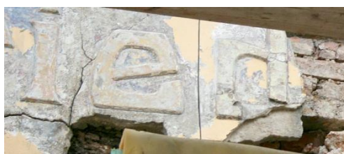
breite Risse im Außenputz (hier in der Schrifttafel) begünstigten das tiefe Eindringen von Schlagregen in die Konstruktion
