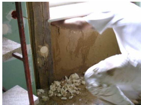
Abb. 102 Aufgrund der guten Bauüberwachung wurde dieses Mal der „Pfusch“ festgestellt und musste zurückgebaut werden. (DFWZ QLB)
