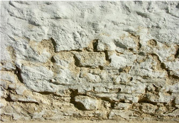
Ablösen der Kalkschlämme besonders im Spritzwasserbereich des Natursteinsockels
