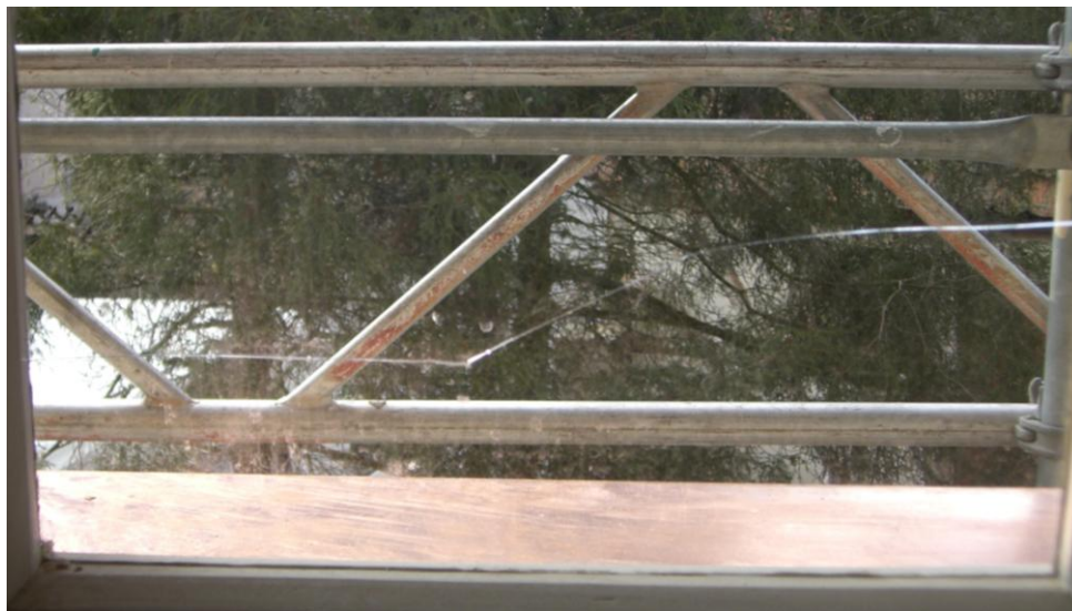
Durch Quellen der Rahmenhölzer gerissene Fensterverglasung
