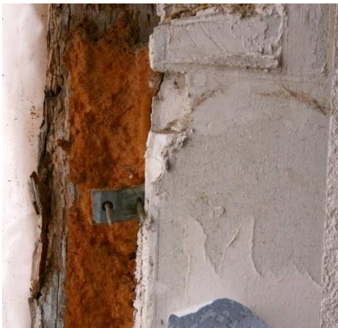
Abb. 40 Durch Hausschwamm massiv geschädigter Fachwerkständer, mit verursacht durch die Verwendung von Bauschaum in den Anschlussfugen (DFWZ)
