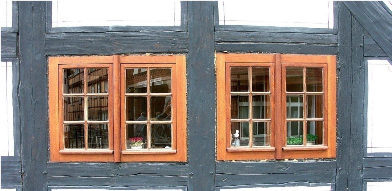
Versprödung und Verwitterung der Korkfüllmasse in Fensteranschlussfugen
