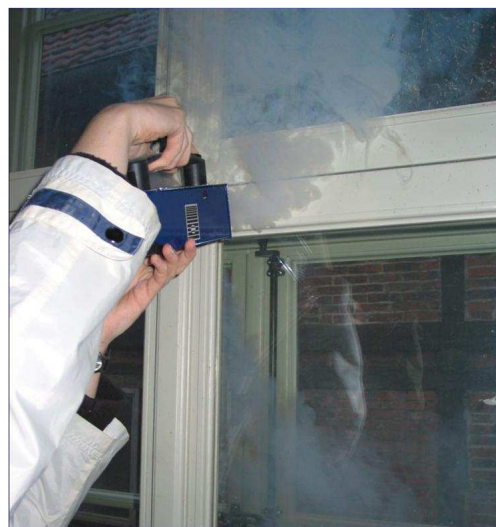
Abb. 89 Nachweis der Undichtheit auf der Innenseite des Kastenfensters, die Dichtung an den Fensterflügeln musste nachgearbeitet werden.
