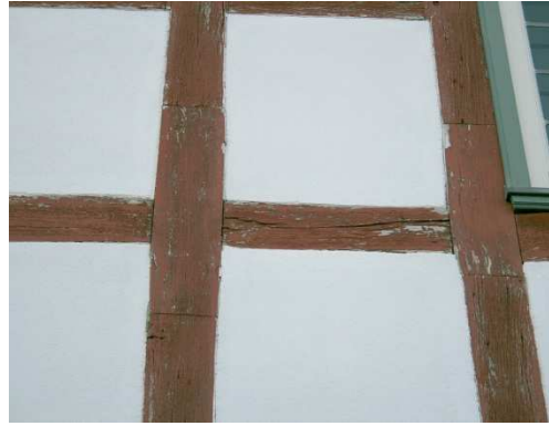
Abb. 25 Rissige und abblätternde Farbbeschichtung der Fachwerkhölzer an der Obergeschossfassade. (DFWZ)
