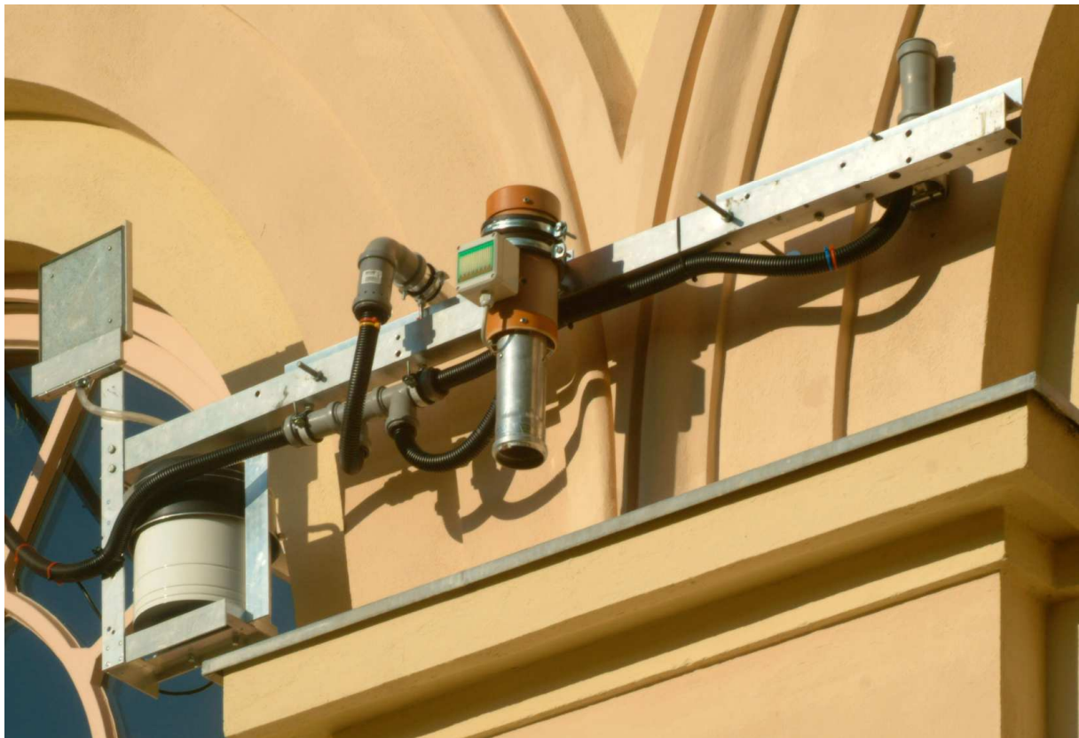
Abb. A 19 Meßbrücke an der Westfassade, von links nach rechts: Ombrometer nach Hellmann, umgerüstet mit vertikalem Auffangpaneel zur Erfassung der Schlagregenmenge; Meßkammer mit Kombisensor Temperatur/ relative Luftfeuchte zur Erfassung der Oberflächentemperatur und der Verdunstung aus dem Putz; Regensensor zur Erfassung der Schlagregenperioden, montiert auf eine ventilierte, strahlungsabgeschirmte Wetterhütte mit Kombisensor zur Erfassung von Temperatur und Feuchte der Luft im Nahfeld; witterungsgeschützter Materialfeuchtesensor. Im Bereich der Oberflächensensoren wurden auf der Meßbrücke Spritzwasserschürzen angebracht.
