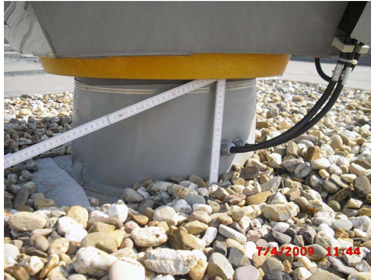
Abbildung 35: Mangel Dachdurchdringung Abluftgerät
