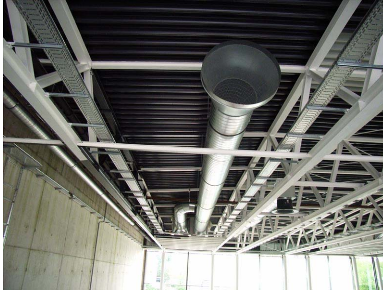
Abbildung 22: Lüftungsanlage mit WRG und Lufterwärmung im Dachtragwerk Sporthalle
