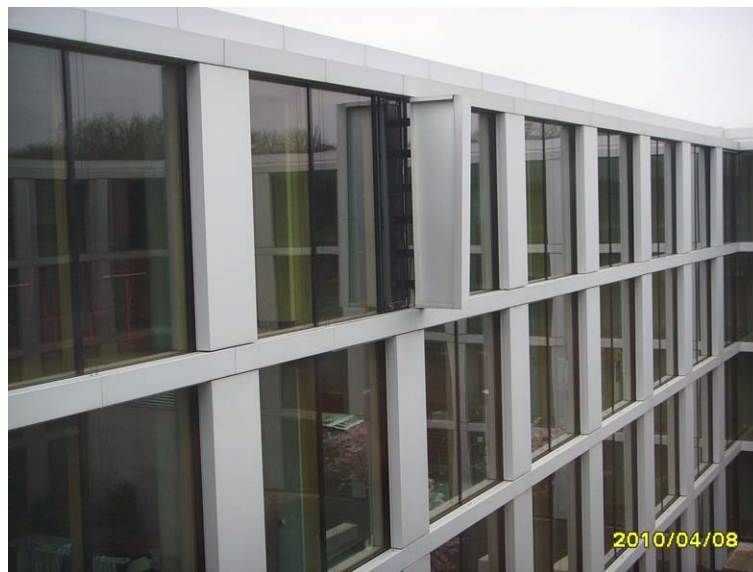
Abbildung 9: Hoffassade Herwig-Blankertz-Berufskolleg - defekte Bekleidung Rauchentlastungsflügel
