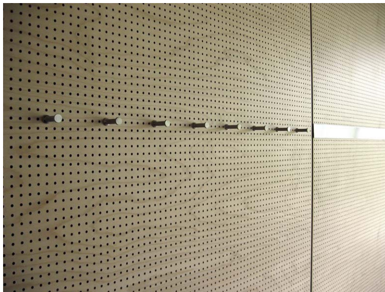
Abbildung 12: Wandbekleidung aus Birke-Multiplex-Platten mit Akustiklochung
