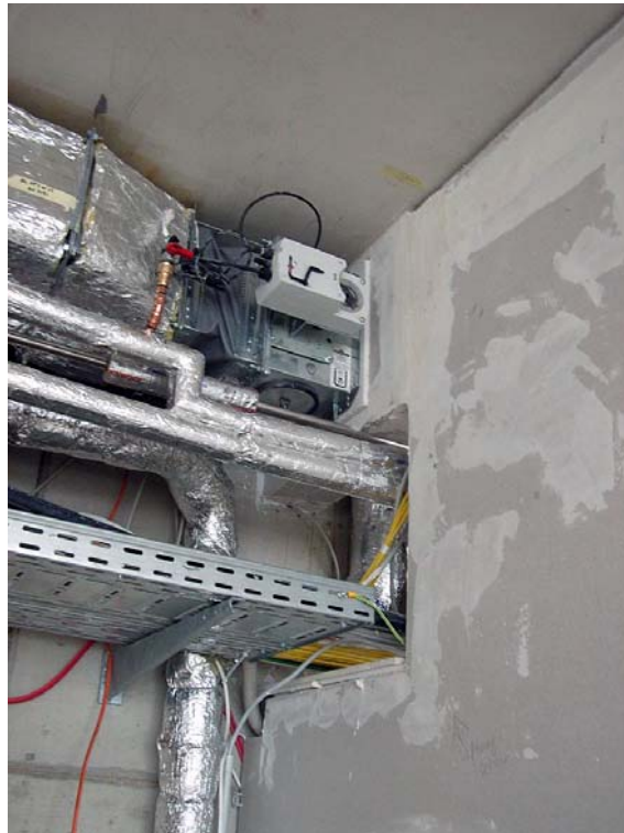
Abbildung 37: Mediendurchführung durch eine Rauntrennwand mit Brandschutzanforderung
