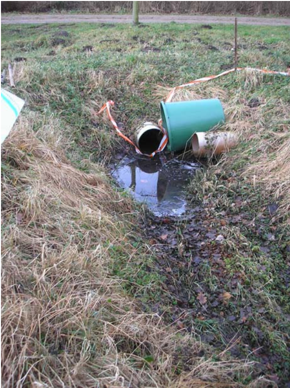
Abb. 15: Auslauf in Grabensystem (Stallgebäude) vor der Sanierung (Februar 2008)
