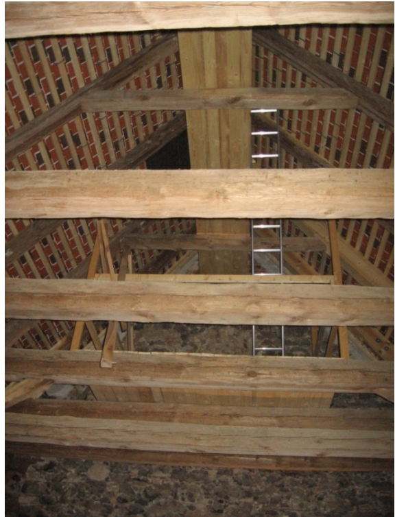
04/2008 : Fertigstellung der Arbeiten im Dachbodenbereich Ansicht des neuen Laufsteges auf dem Hahnbalken mit Zwischenpodest und Leiteraufgang für die Begehung des Fledermausquartiers
