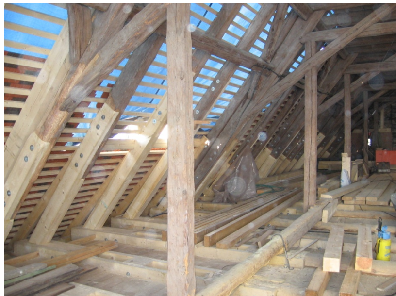
Abschnittsweises Vorgehen beim Wechsel der Fußschwelle, Binderkonstruktionen, Sparren, Deckenbalken zur Gewährleistung der Stabilität
