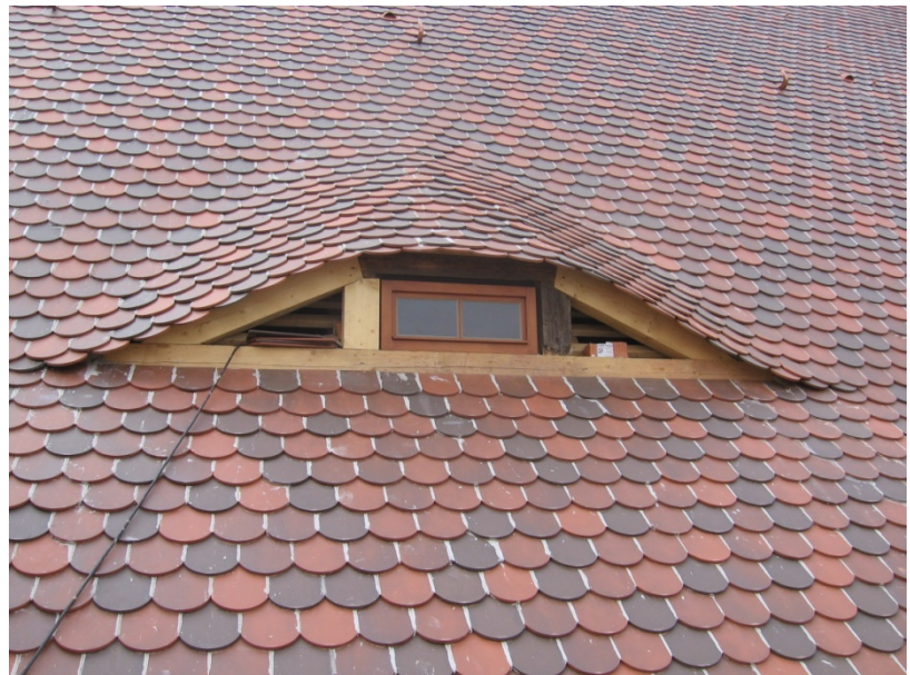
Fledermausgaube, darüber Fledermausziegel angeordnet, Fenster auf der Südseite werden als Einflugöffnung für Fledermäuse von April bis September ausgehen
