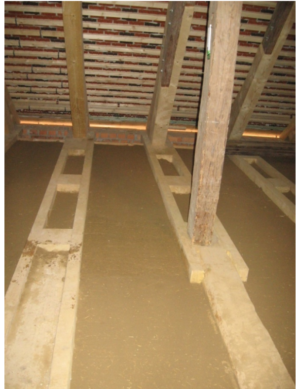
04/2008 : Wiederherstellung des Lehmverstriches auf der Kirchendecke als Klimapuffer entsprechend historischem Bestand erst ab Temperaturen über ca. 10°C verarbeitbar
