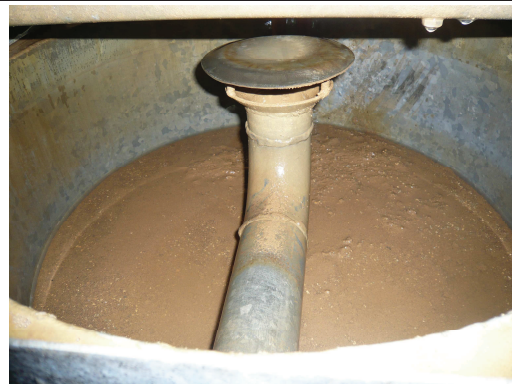
Eisenablagerungen auf der Filtermaterialschtüttung nach der Spülung
