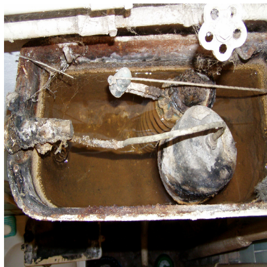
Toilettenspülkasten (Hotelzimmer, innen) als Beispiel für Ablagerungen
