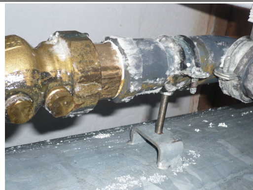
Feuchtigkeitsschäden (Pilze, Bakterien) auf der äußeren Oberfläche der Aufbereitungsanlage
