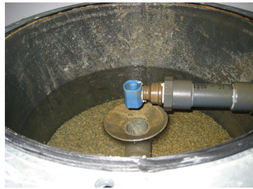
Oberfläche Filtermaterialschtüttung vor Spülung
