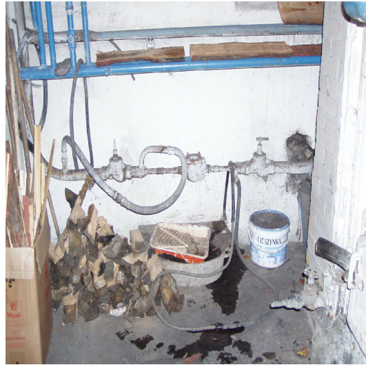
Hausanschluss mit Wasserzähler
