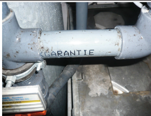
Feuchtigkeitsschäden (Pilze, Bakterien) auf der äußeren Oberfläche der Aufbereitungsanlage
