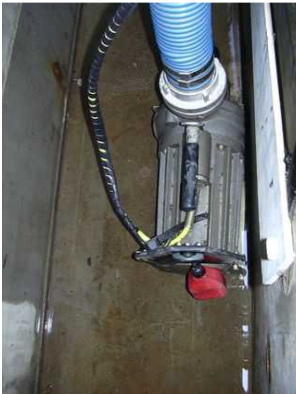
Abbildung 32: Pumpe im Kanal
