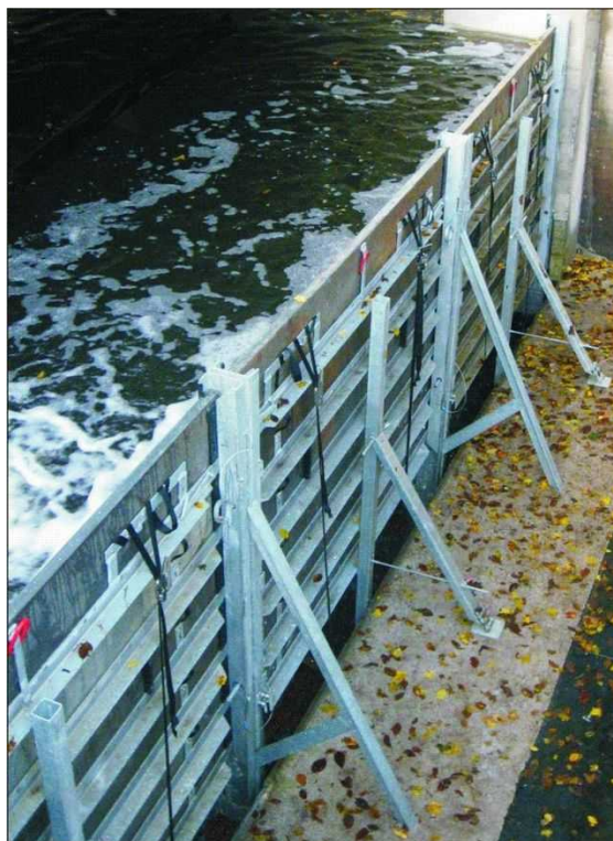
Abbildung 1: Die WasserWand im aufgebauten Zustand in der Referenzanlage
