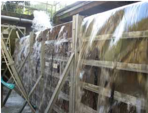
I. Überflutung auf der Trockenseite
