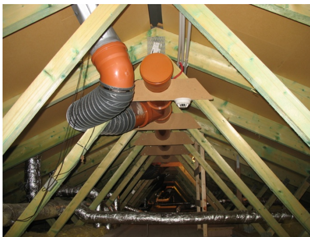
Abbildung 3: Luftsammeltrichter mit Rohrsystem und Sammelrohr.
