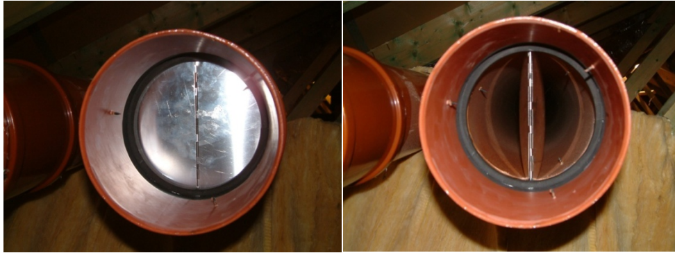
Abbildung 7: Rückschlagklappe in der Verrohrung im geschlossen bzw. geöffneten Zustand.
