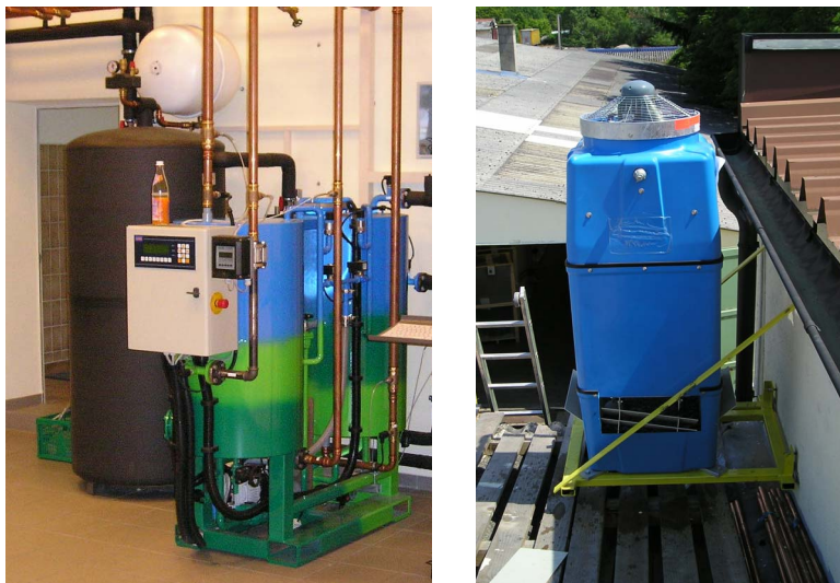
Abbildung 8: links – KAKM im Schulungsraum der Fa. Citrin Solar rechts – offener Verdunstungskühler zur Rückkühlung
