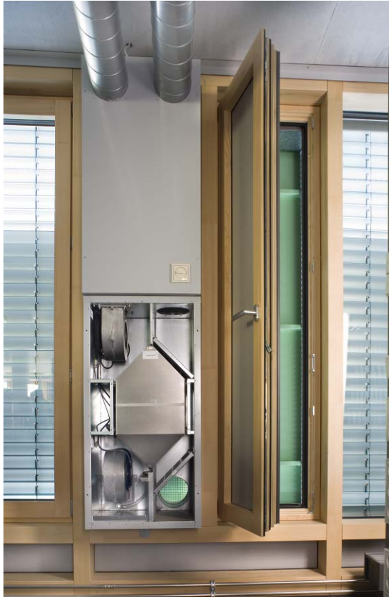
Abb. 3: Lüftungsflügel und Lüftungsgerät
