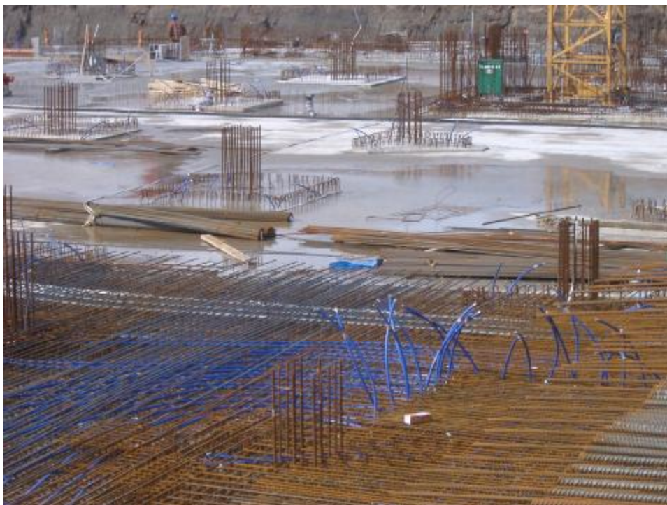
Abbildung 38: Geothermie in der Umsetzung: Mit Kunststoffrohren belegte Armierungskörbe der Gründungspfähle (oben links), Verlegung der Anbindeleitungen in der Bodenplatte (unten), fertiger Verteilerbalken in der Tiefgarage (oben rechts)
