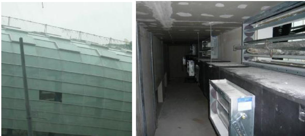
Abbildung 37: Motorisierte Fassadenklappen (links) und Lüftungsöffnungen im Raum zum Fassadenzwischenraum für die natürliche Lüftung im Bereich Elemente
