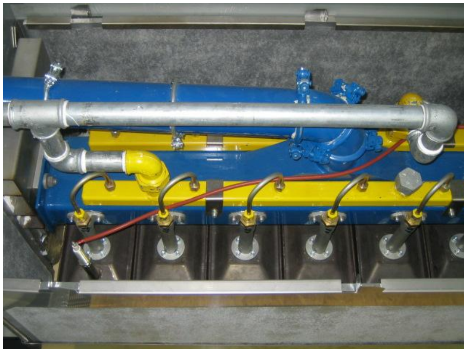
Abbildung 12: Detail der Gasheizung von oben gesehen
