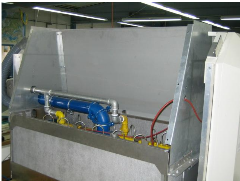
Abbildung 10: Gasheizung- Ansicht von oben – dem Druckkopf vorgelagert
