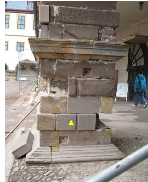
Bild 8-7: Vierungen aus Lauterbacher Lettenkohlendstein (gelber Pfeil)
