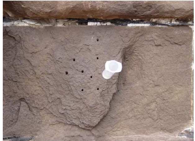
Bild 6-5: Nordseite des Pfeilers TF-2 mit einer Probefläche unmittelbar nach dem Festigen/Hinterfüllen mit Epoxydharzlg. 20%ig
