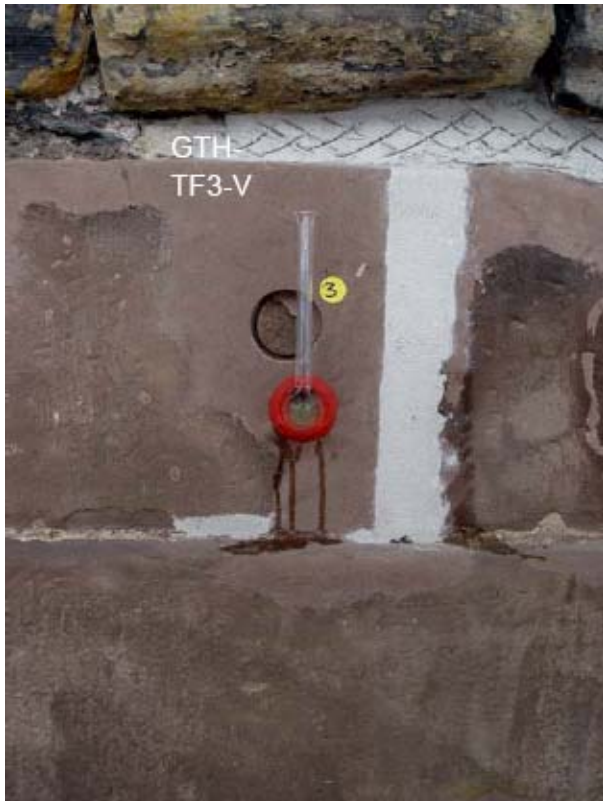
Bild 6-14: Nach Norden exponierte Fläche des Pfeilers TF-3: Neue Tiefenverfugung mit Oberflächenstrukturierung für eine gute Anbindung der Deckverfugung unter einem Gesims (oberer Bildbereich) und Fuge mit fertiger Deckverfugung
