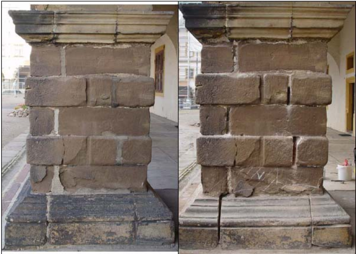
Bilder 6-1 und 6-2: Nach Süden exponierte Seite des Pfeilers „TF-3“ vor und nach der Entfernung von Altmörteln
