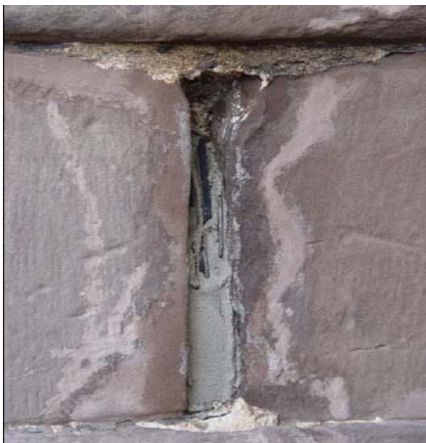
Bild 6-12: Nach Süden exponierte Fläche des Pfeilers TF-3: Neue Tiefenverfugung und Auswicklung mit Schieferplatten
