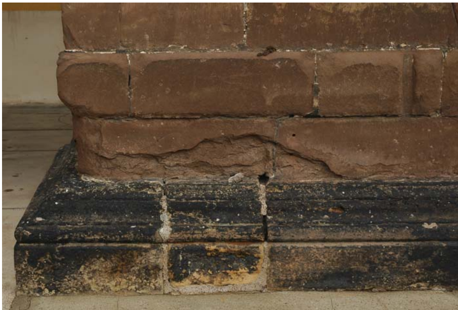
Bild 4-2: Typische Schalenbildungen am Lettenkohlsandstein Der Sockel besteht aus dichterem Räsandstein und bewirkt einen Feuchtigkeitsstau im stark saugenden Lettenkohlsandstein, wenn dieser durchfeuchtet wird.
