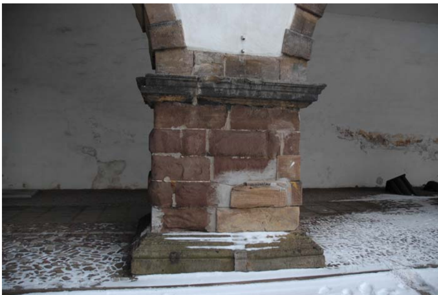
Bild 4-1: Pfeiler, an dem deutlich wird, dass es an den Lettenkohlsandsteinen kaum noch originale Oberflächen gibt (zum Vergleich Seeberger Sandstein unten rechts).
