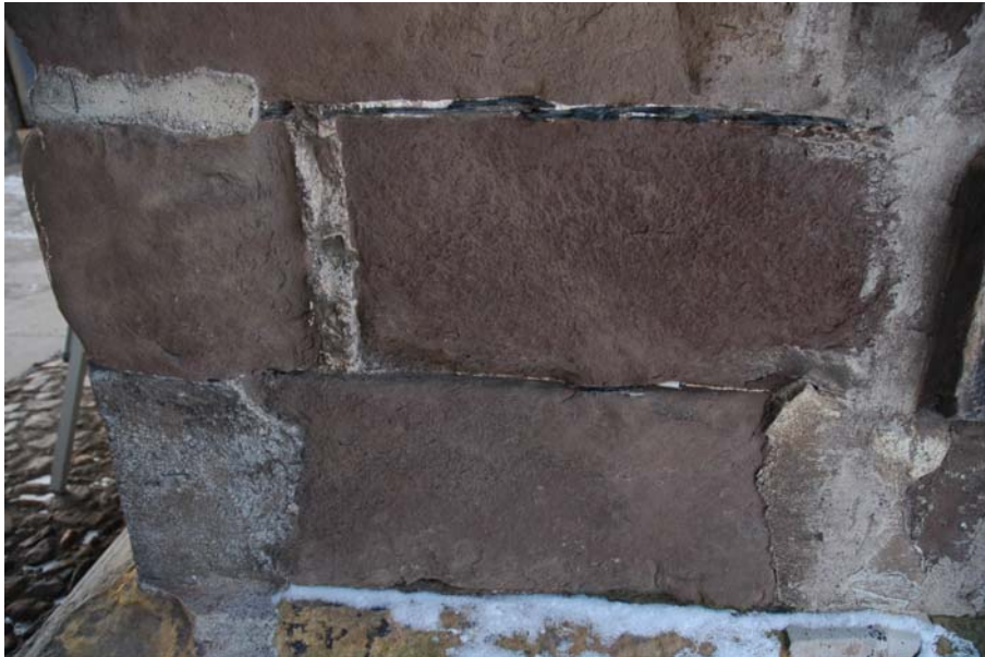
Bild 4-6: Mörtelergänzungen, breite Fugen und Abblätterungen
