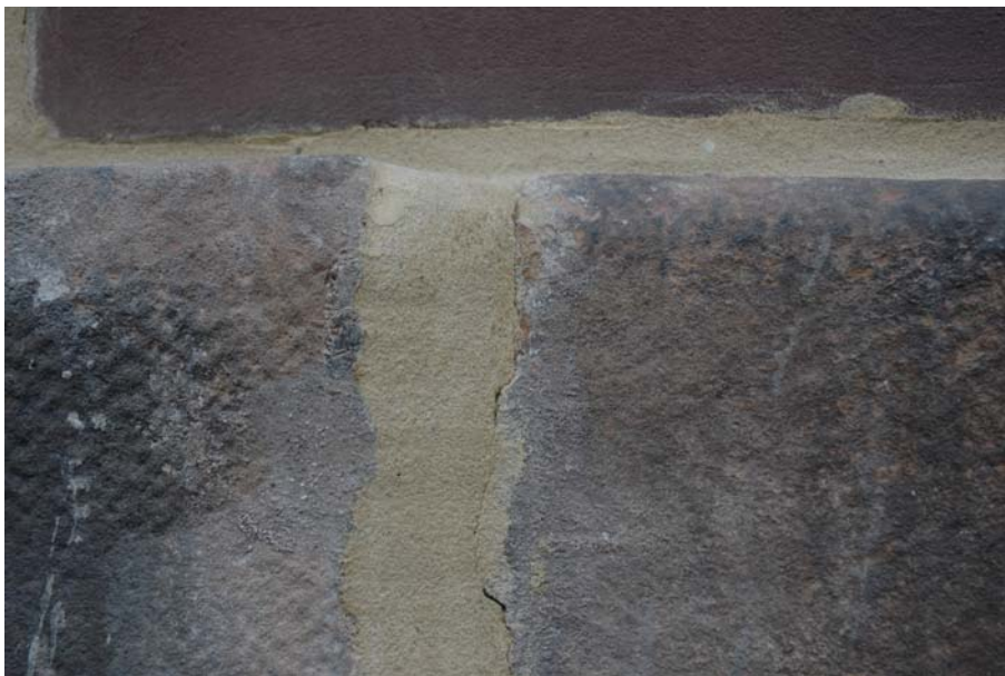
Bild 9-1: Haarriss im Fugenmörtel, entlang der Steinflanke
