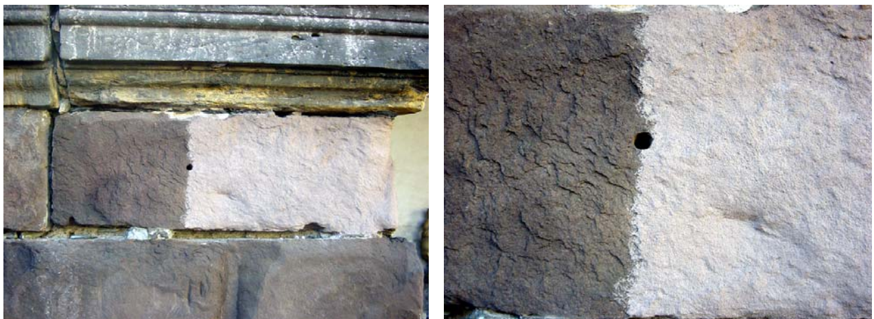
Bilder 5-2 und 5-3: Probefläche an einem Pfeiler auf der Südseite des Schlosshofs
