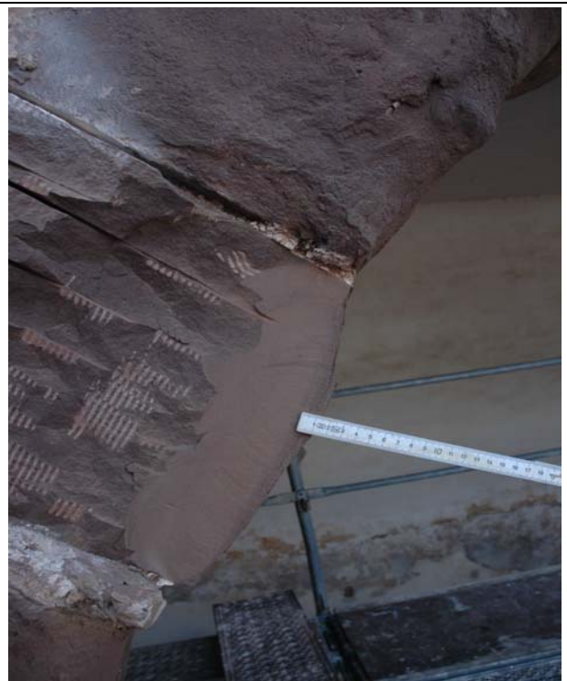
Bild 8-6: Eindringtiefe (ca. 1 cm) des Festigers an überhängenden Bossen nach der Hauptfestigung
