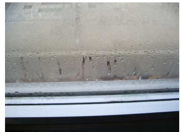
Abbildung 190 Isolierglas - Wasser im SZR
