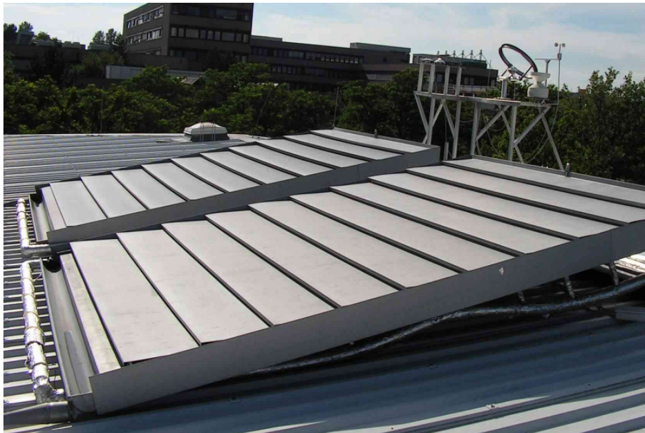
Abbildung 2: Zwei Kollektorfelder mit je neun QUICK STEP SolarThermie Paneelen (Fa. Rheinzink) auf dem Dach des ZAE Bayern (Würzburg). Die obersten Elemente sind lediglich Andeckbleche. Rechts im Hintergrund die Wetterstation.
