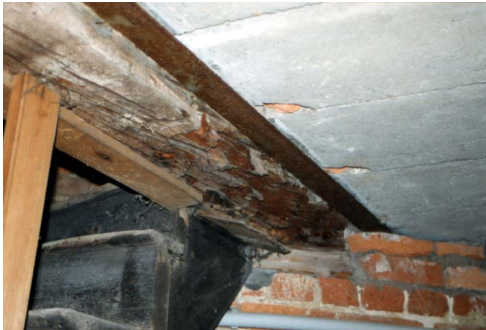
Abb. 9: Decke zwischen Uhrenebene und Türmerstube (Ebene 7), Deckenbalken stark geschädigt durch den Echten Hausschwamm, Eisenträger späterer Instandsetzungen sind verrostet
