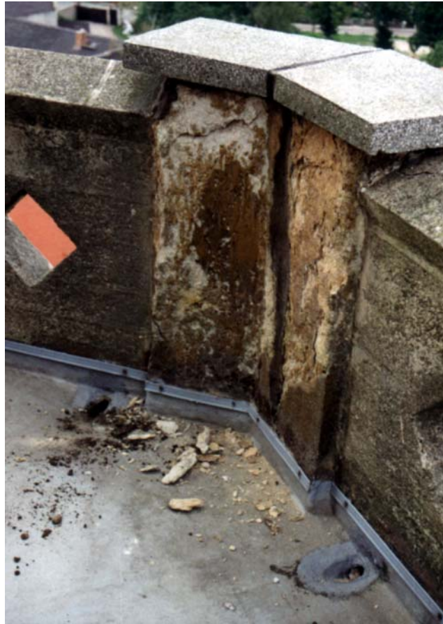
Abb. 3: Detailaufnahme der geschädigten Turmbrüstung, hier: Pfeiler mit Rissen
