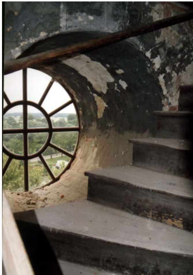
Abb. 10: Treppe von der Uhrenebene zur Türmerstube (Treppe im Bereich des Echten Hausschwammes, Ausbau)
