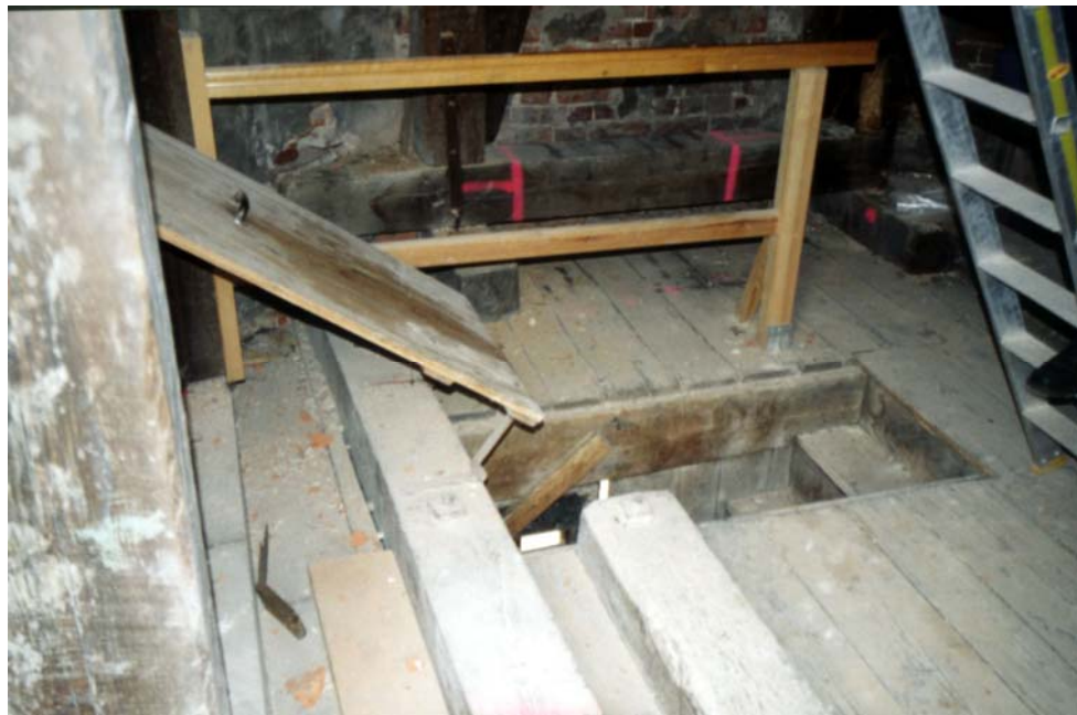
Abb. 8: Ebene der Aussichtsplattform (Ebene 8) vor der Sanierung, Durchstieg (Lücke) wie Abb. 7, von oben
