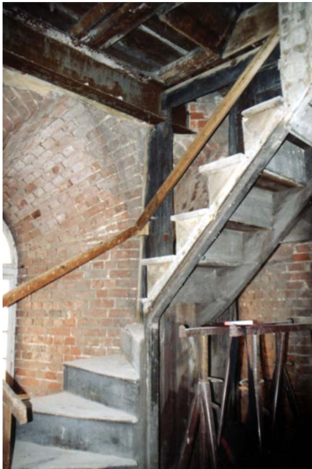
Abb. 5: Holztreppe im schwammgeschädigten Bereich (Türmerstube)
