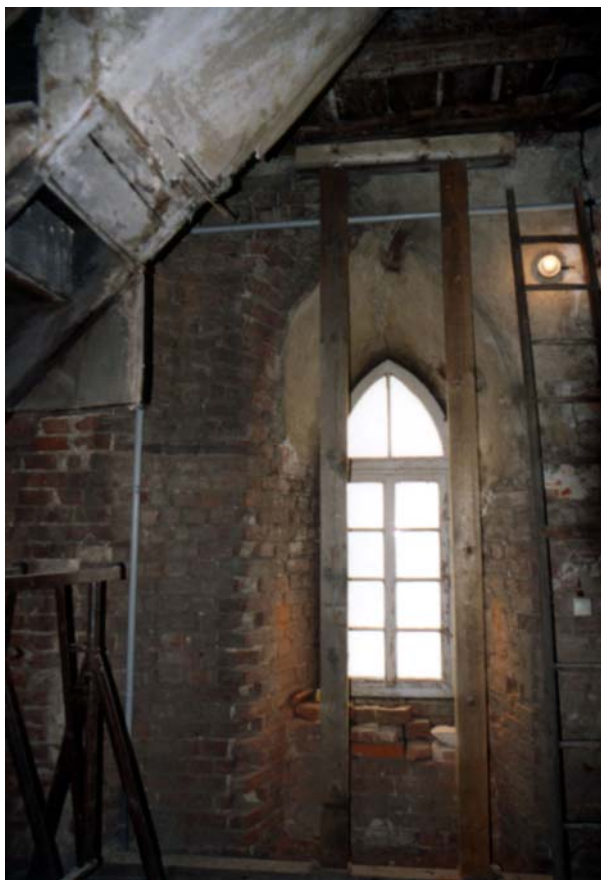
Abb. 6: Türmerstube mit Abstützung der stark geschädigten Decke
