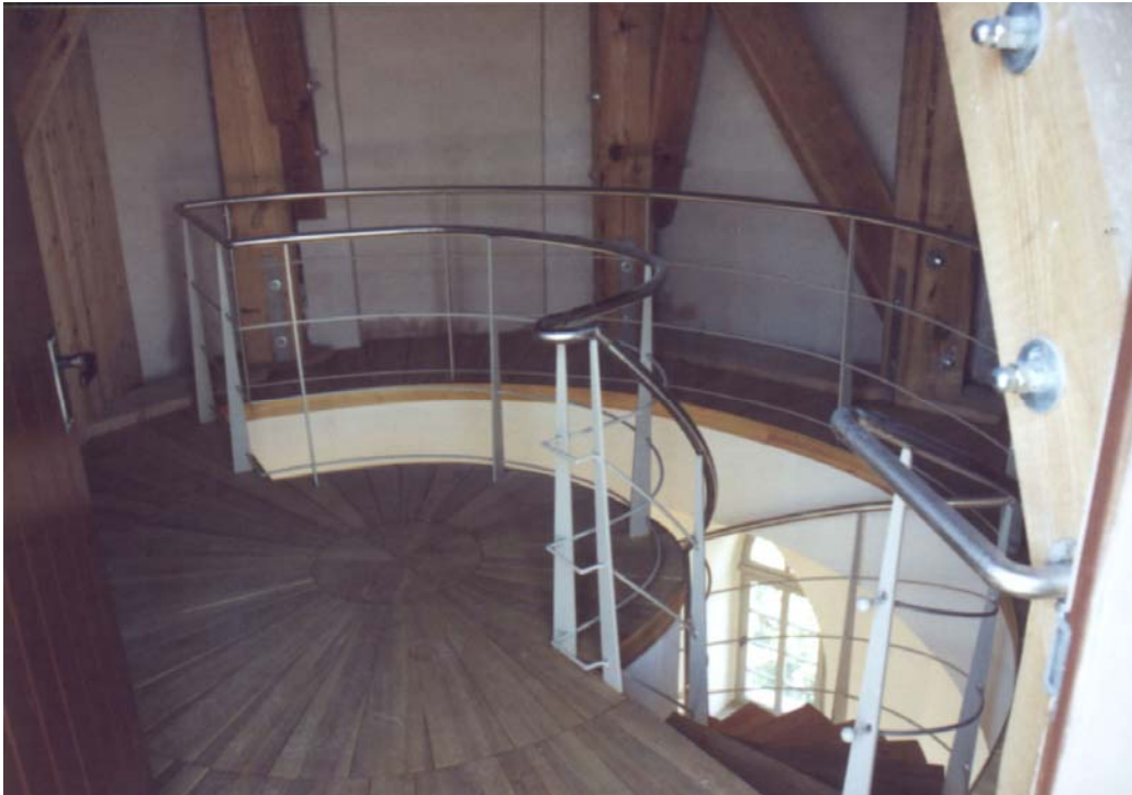
Abb. 17: Die Aussichtsebene mit dem Aufgang von der Türmerstube (vergleiche Abb. 8!) im Hintergrund sind die Stiele zu erkennen, welche die Konstruktion der Turmspitze tragen
