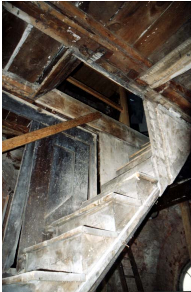
Abb. 7: Treppe und Durchstieg zur Ebene der Aussichtsplattform (Decke und Treppe stark geschädigt durch den Echten Hausschwamm)
