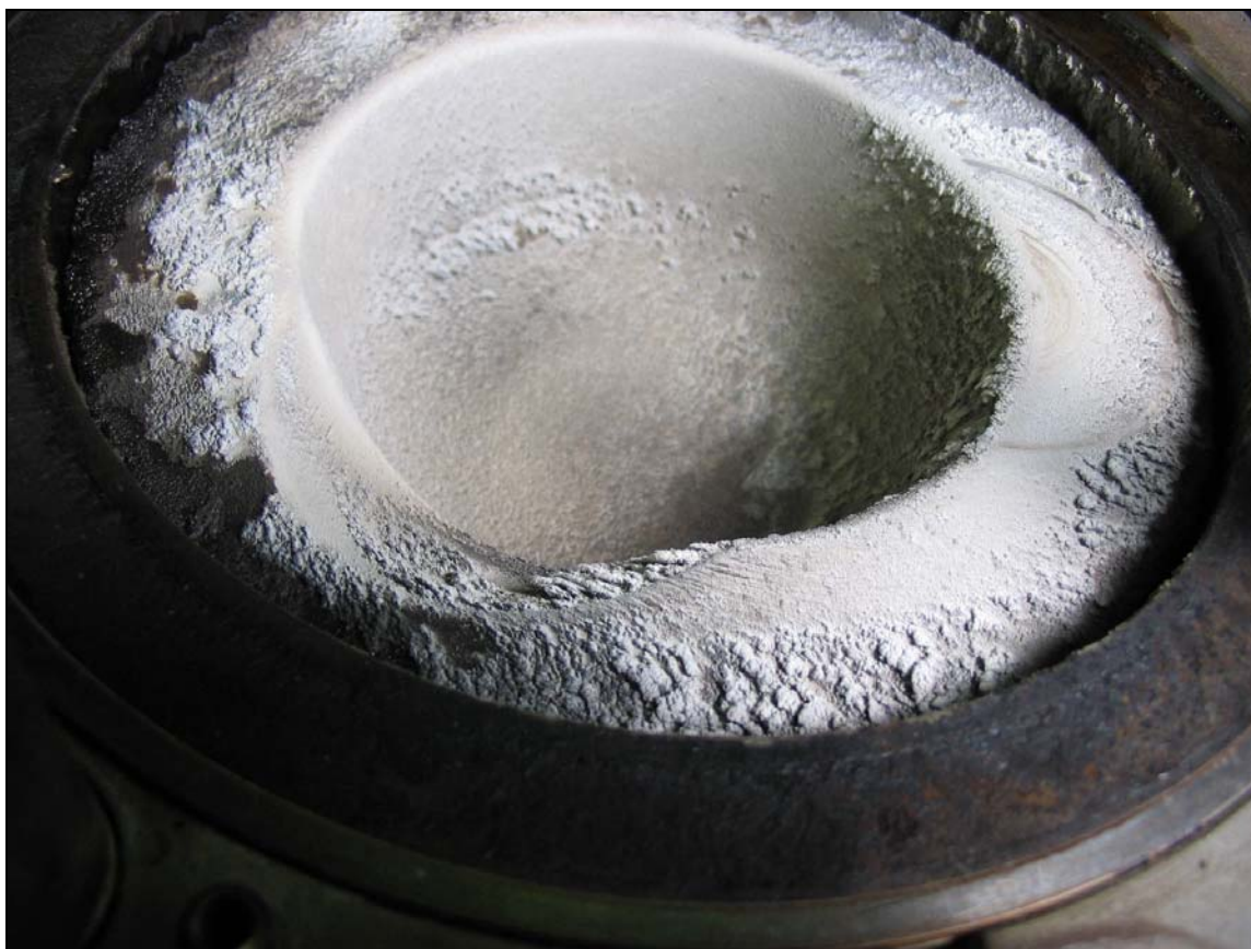
Abbildung 5-16: Ablagerungen im Brennraum des BHKW
