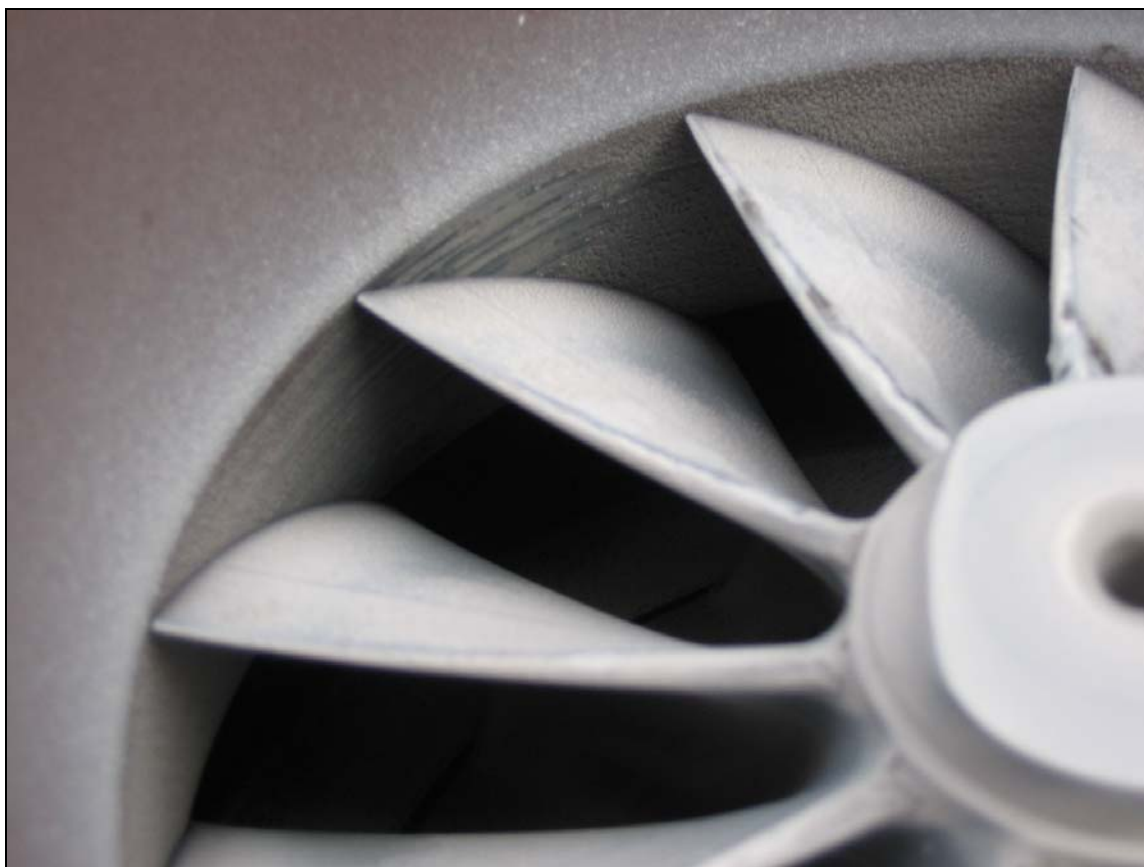
Abbildung 5-17: Ablagerungen am Turbolader des BHKW
