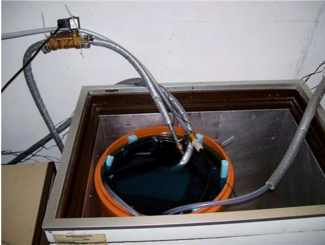
Bild 9: Tiefkühltruhe mit eingebauten Vorrichtungen zur Abwasserkühlung
