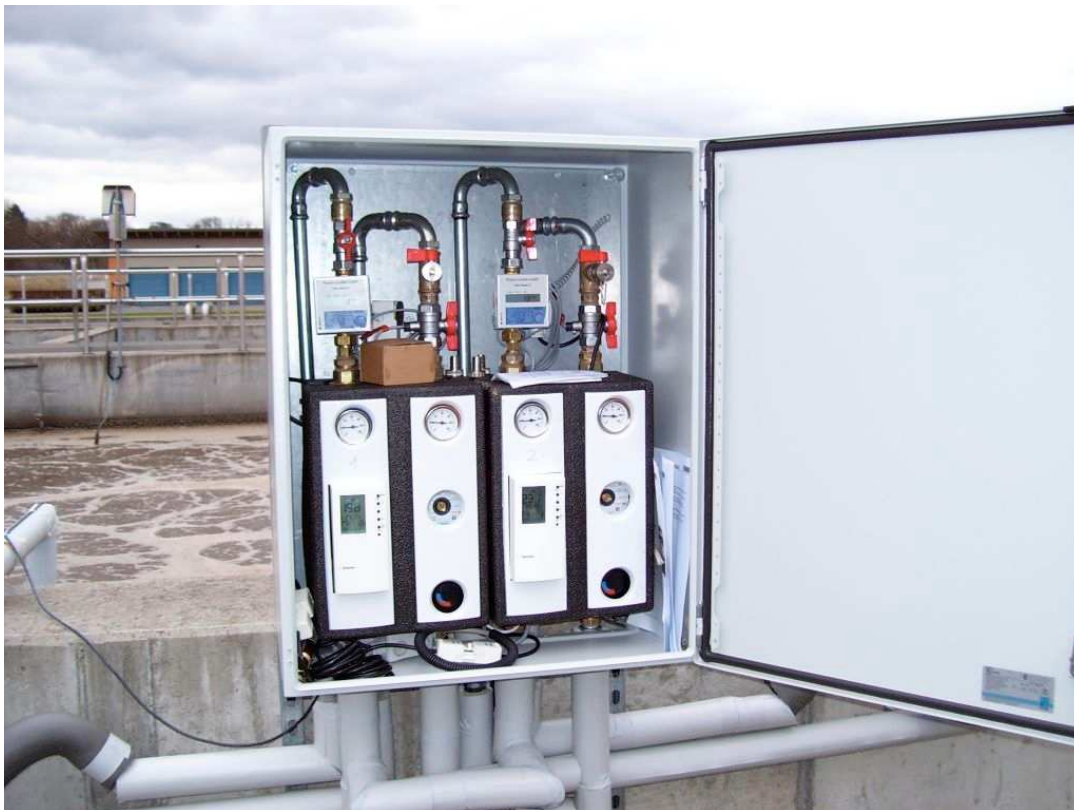
Bild 5: Steuer-, Regel- und Messschrank
