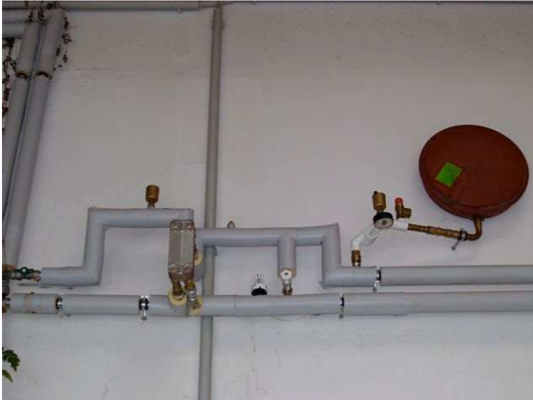
Bild 3: Heizwasserentnahme aus dem Kläranlagenkreislauf. Mitte-links ist der Wärmeaustauscher und rechts das runde Ausdehnungsgefäß angeordnet.
