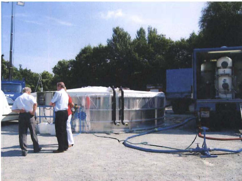
Abb. C-32: Trinkwasserlagerung im 25 m 3 SMB – Rechts Trinkwasseraufbereitung/KRUPP-TWAA
