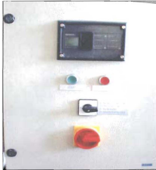
Abb. C-10: Frontansicht elektrotechnischer Anlagenblock
