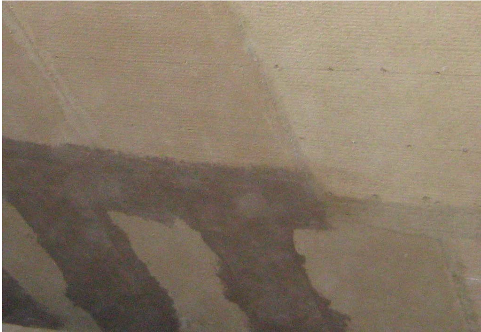
Abb. 2.44: Lehmbauplatten, Fugen armiert mit CELLCO – Contact - Mörtel und einen Gewebe, Machenweite 8 x 8 mm, Überdeckung von je 10 cm
