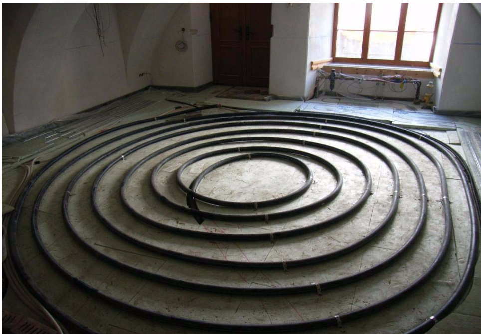
Abb. 3.19: Fußbodenabwasserheizung, 60 m PE 50 im Erdgeschoss
