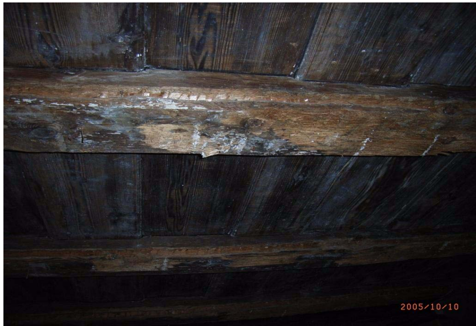
Abb. 1.4: Decke über dem 1. OG Nord, Kriech- und Deckerdecke, starke Schädigung der Oberfläche der Balken und Querschnittverlust
