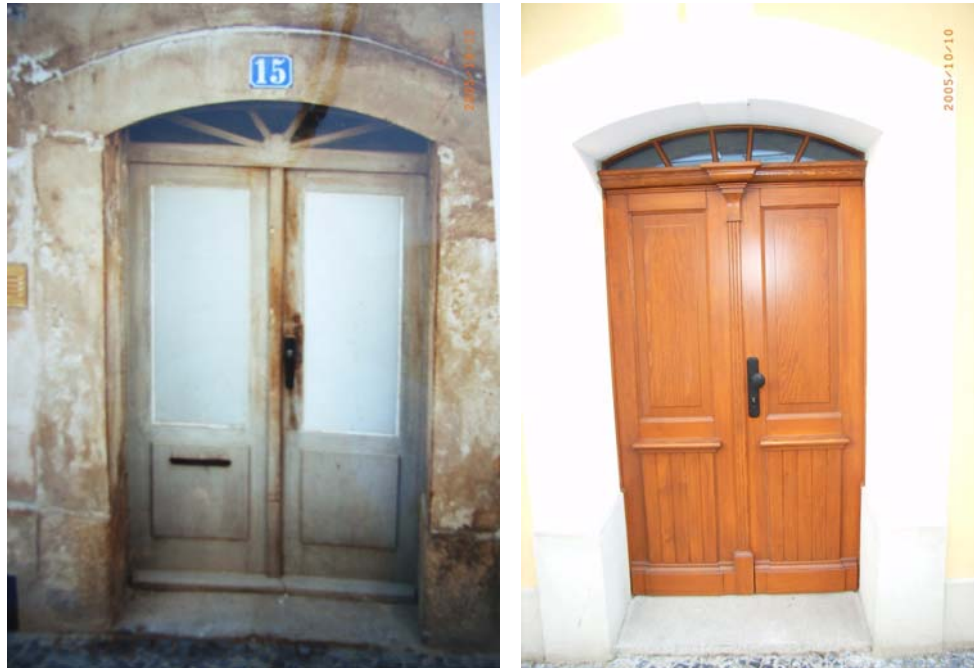
Abb. 1.10: Hauseingangstür, schadhafte Hauseingangstür aus dem 20. Jahrhundert (links), Anfertigung nach der in der Bauakte vorgefundenen Originalzeichnung (rechts)
