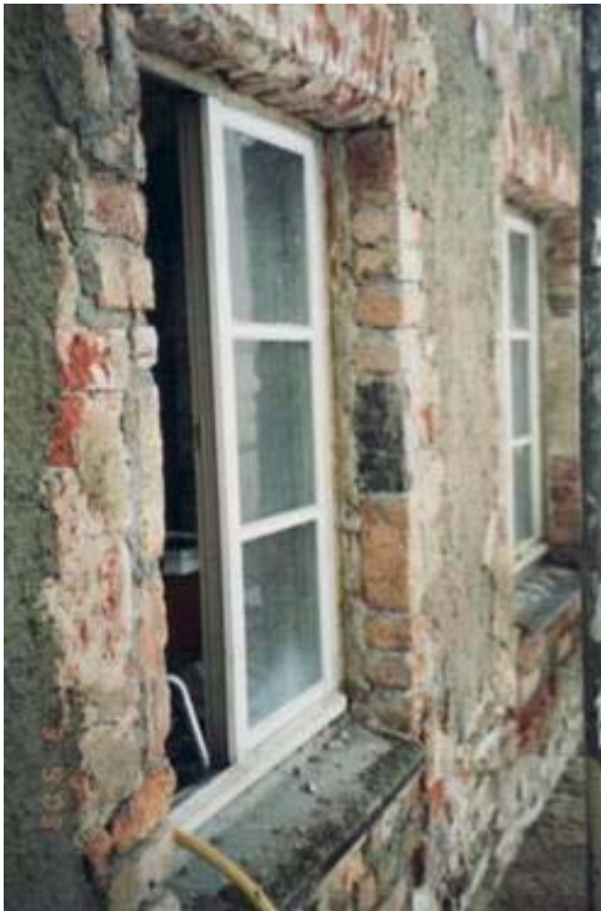
Abb. 2.14: Straßenfassade, aufwendige Sanierung des vorhandenen Mauerwerkes, Fensterleibung von der Sanierung aus den 1970er Jahren
