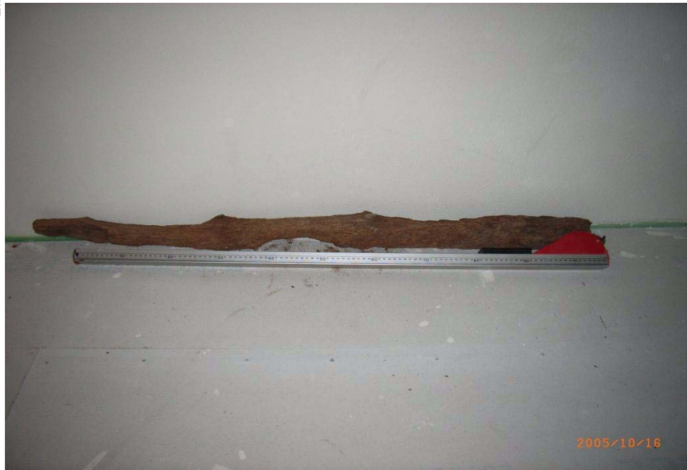
Abb. 2.33: Detailaufnahme der Fußfette straßenseitig, beim Rückbau vorgefundene Reste einer ca. 6,50 m langen Fußfette, starke Querschnittsverluste durch Fäulnis und Pilzbefall - akuter Sicherheitsbedarf
