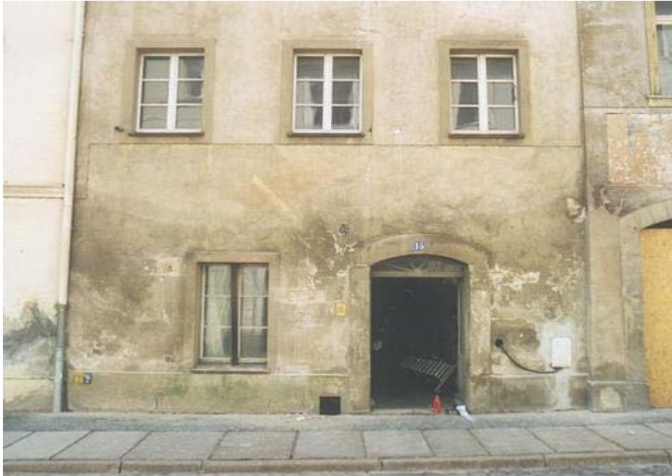
Abb. 2.8: Straßenfassade, Salz und Feuchteschäden an der Erdgeschossfassade
