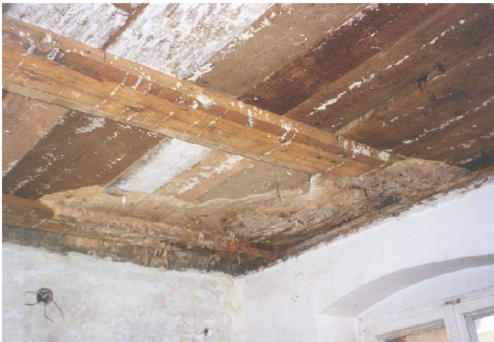
Abb. 2.35: Befall der Decken und der Dachkonstruktion durch echten Hausschwamm
