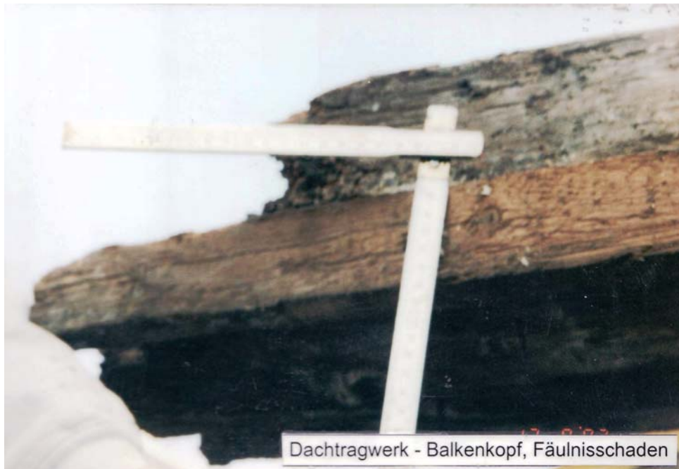
Abb. 2.34: Detailaufnahme eines Balkenkopfes, starke Querschnittsverluste durch Fäulnis und Pilzbefall - akuter Sicherheitsbedarf
