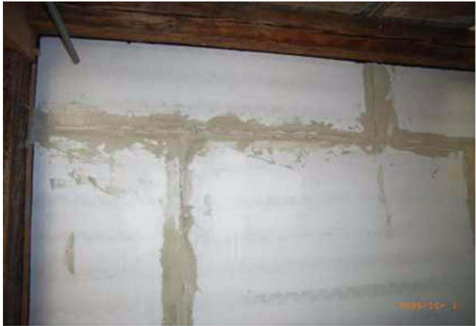
Abb. 2.18: Haustrennwand im 2. DG, West, Calciumsilikat zur Herstellung der Brandwände und als Wärmedämmung
