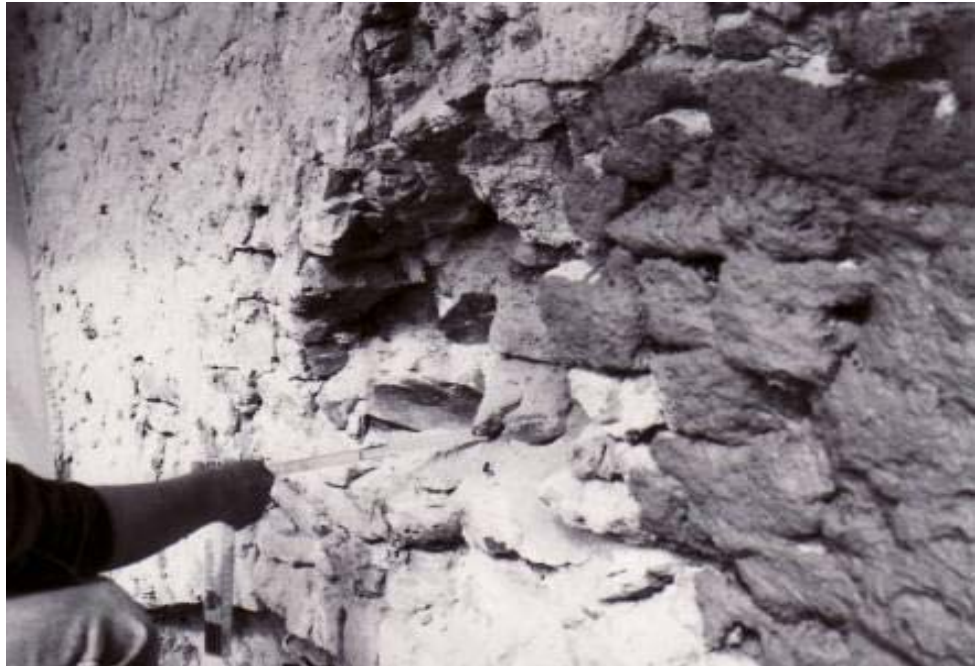
Abb. 2.10: Hoffassade, stark geschädigtes Mauerwerk, Detail
