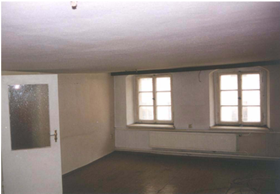
Abb. 2.27: Decke über dem 2. OG geschädigt und nicht tragfähig, mit abnormen ca. 20 cm starken Verformungen - vermutlich vor dem Einbau der 11,5 cm Wand überbelastet, Verformungen durch langzeitigen Feuchte- und Lasteinfluss irreversibel
