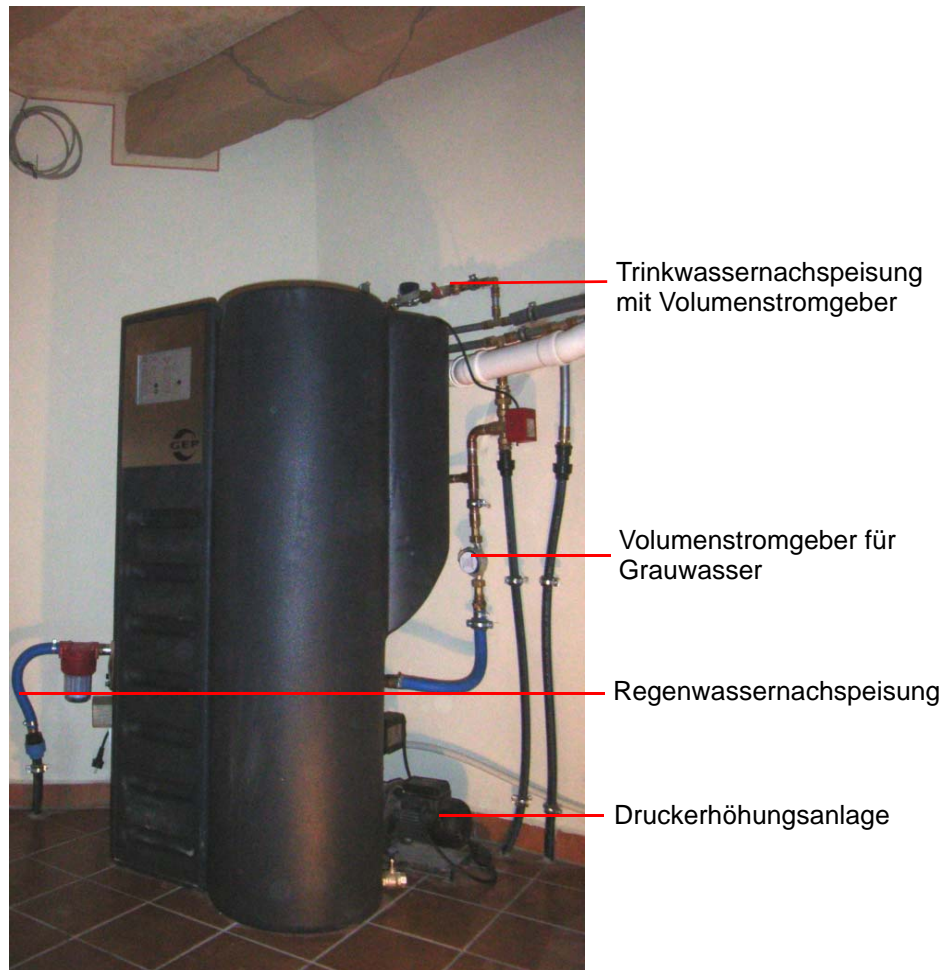
Abb. 3.16: GEP - Grauwassernutzungsanlage IWM-Wassermanager WME 4, 300 l/d Aufbereitungsleistung, B/T/H: 75 cm/ 70 cm/ 150 cm [13]
