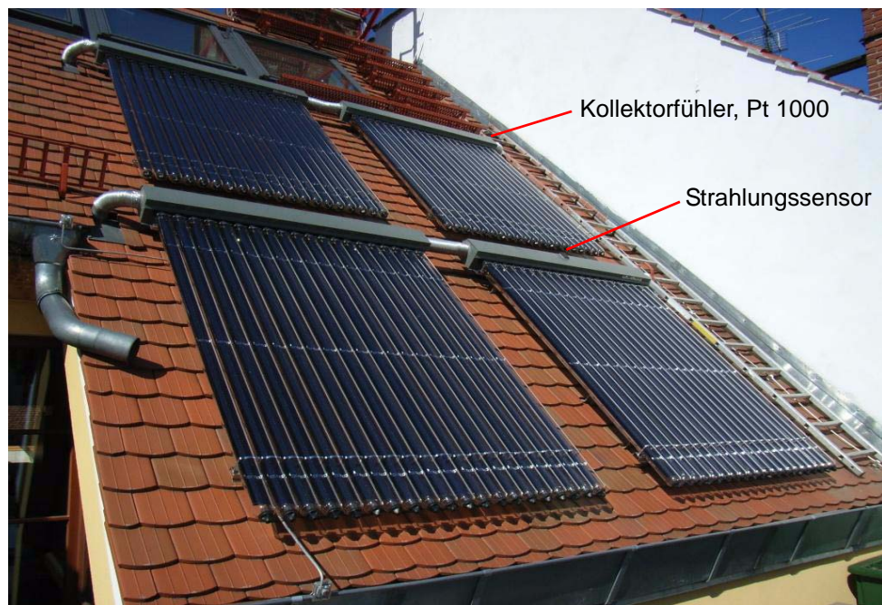
Abb. 3.9: Vakuum - Röhrenkollektoren, geschlossene Dachhaut, rückbaubare Anlage
