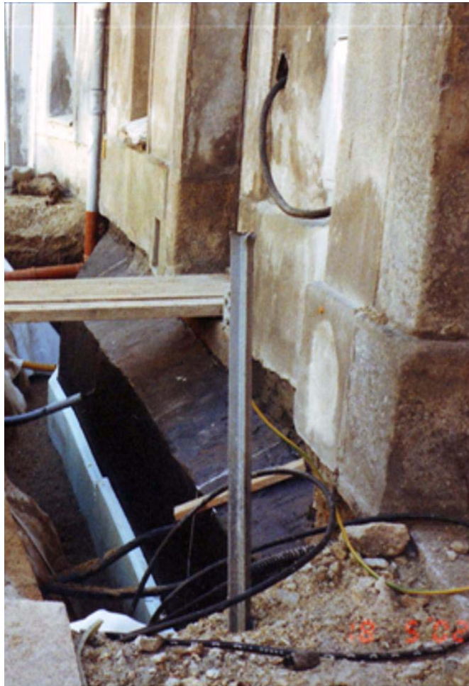
Abb. 2.21: Straßenfassade, vertikale Abdichtung mit einer Dickbeschichtung auf der Vorsatzschale aus Beton, Perimeterdämmung
