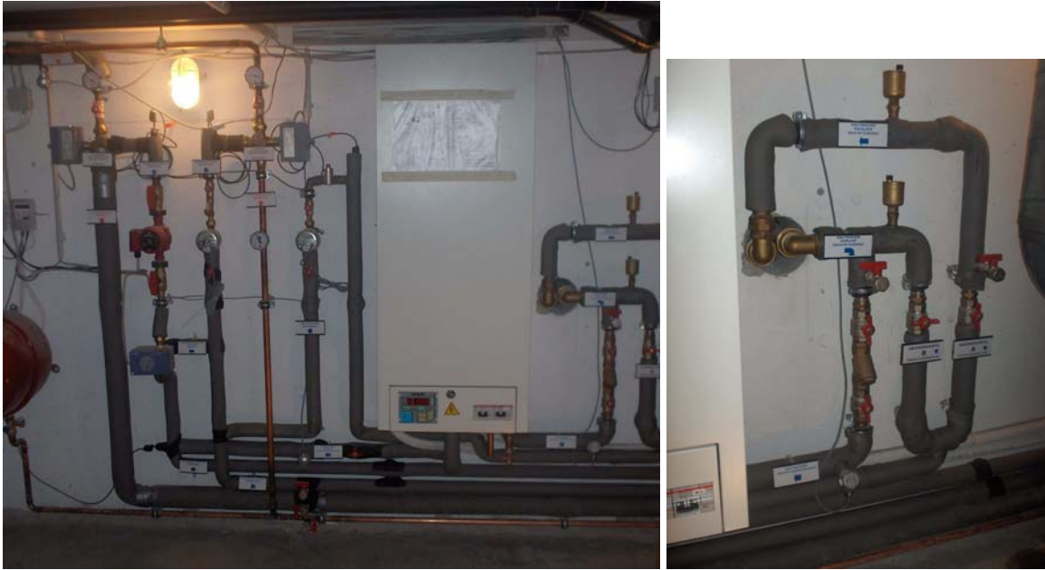
Abbildung 4.2: Foto des Kaltwassergerätes (links) und Anbindung der Erdsonde in die Anlage (rechts)
